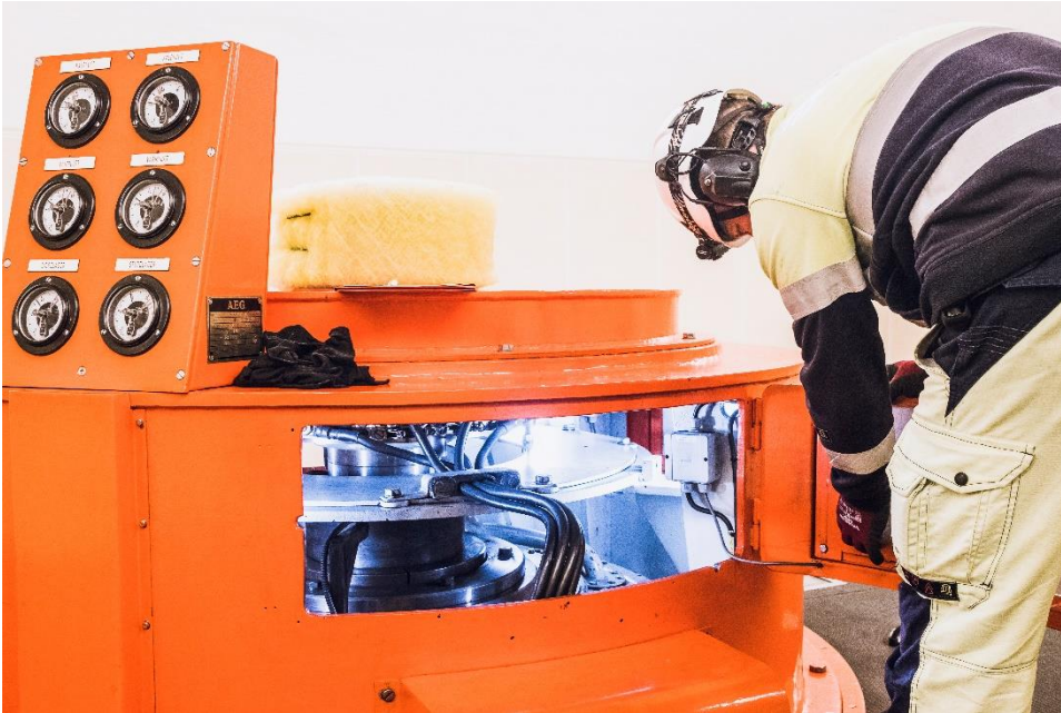
Figur 19 Foto fra Skagerak Kraft – Generatortopp på Hjartdøla Kraftverk
