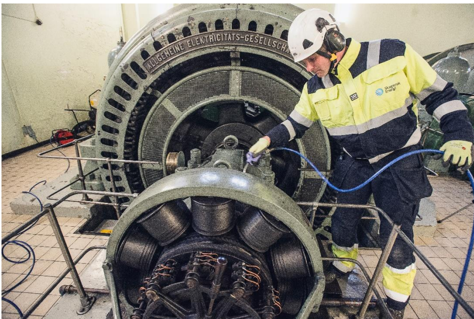
Figur 15 Foto: Skagerak Kraft, Generator fra 1907 ved Gamle Dalsfos Kraftverk
