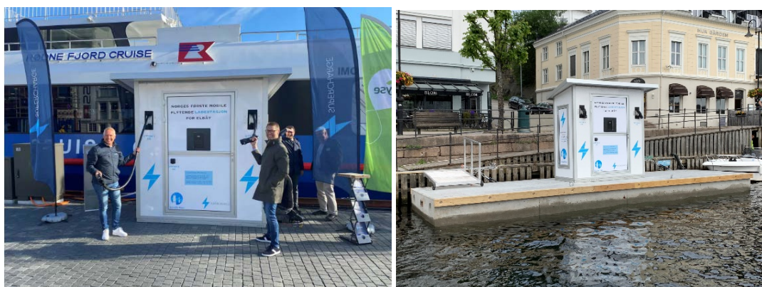
Figur 21: Flytende ladestasjon 100-200 kW, med to stk. CCS2 tilkobling fra Supercharge. Foto: Supercharge
