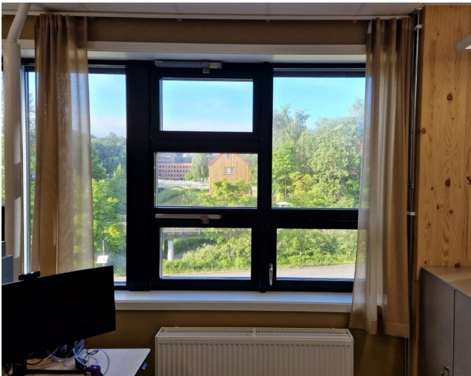
Figur 3.9: Motorstyrte vindauger for automatisk lufting av kontorlokala.
