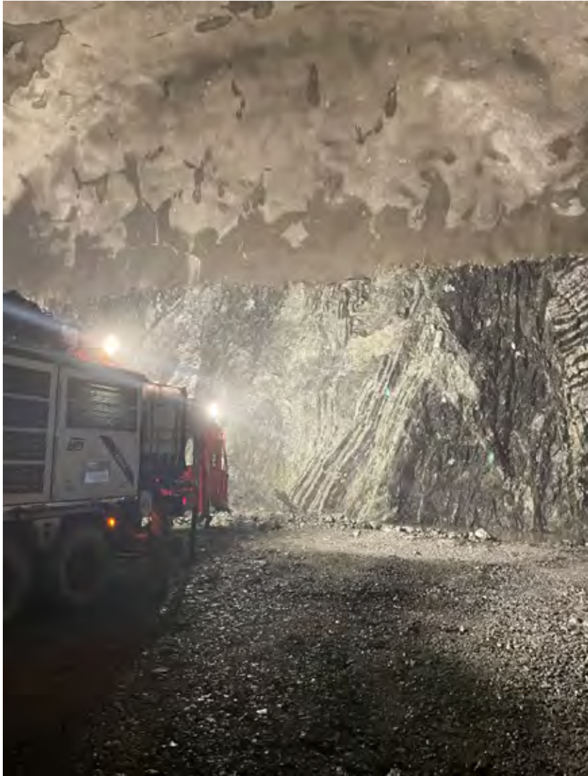
Figur 14 Foto fra endevegg i en av hallene. Bildet viser sikringen av endeveggen i takskiva og stoffen på liggerpall. Foto VAV
