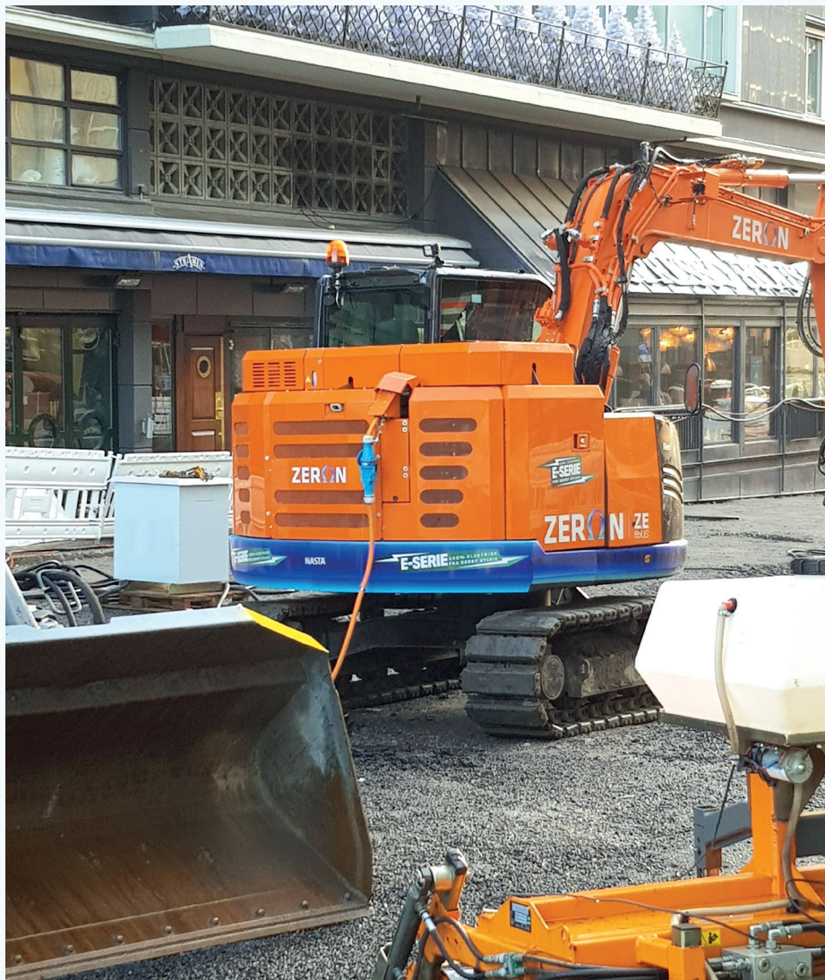
Nesten 95% av klimagassutslippene i byggefasen kommer fra dieseldrevne anleggsmaskiner og tungtransport. Hvis Norge skal oppnå klimamålene sine, må bygge- og anleggsplasser elektrifiseres. Her er en utslippsfri gravemaskin på byggeplass i Olav Vs gate i Oslo. Foto: SINTEF
