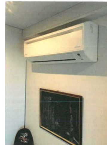
Varme er godt! Har varmepumpe og kabler i golv. Luksus! Slipper å fryse...
