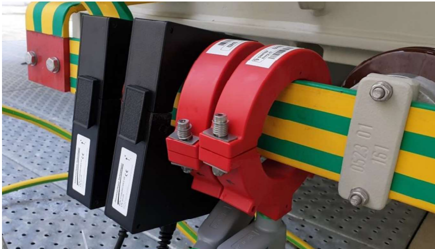
Figur 3: Fire GIC-sensorer montert på jordskinnen/nøytralpunktet på en 420 kV transformator i Trøndelag. De to svarte sensorene er fra Advanced Power Technologies, de to røde fra Dynamic Rating. Sensorene har måleområde +/-50 A og +/-500 A.
