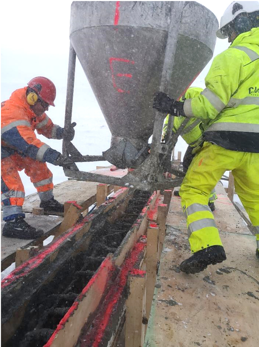
Figur 34: Hektisk aktivitet hos Fjellbyggs arbeidere som er i ferd med å tømme en standardtobbe. Snøkov som følge av helikopterets rotorer som dundrer 15 m over. 10.11.2020
