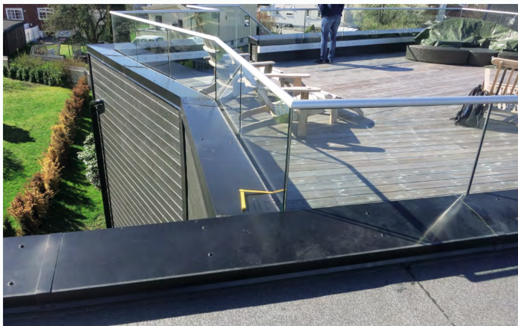
Flate tretak uten takutstikk, gjerne kombinert med terrasse på takflaten og utvendige nedløp, skaper mange utfordringer. Stikkord er drenering, lufting og inntrengning av fukt fra nedbør.
