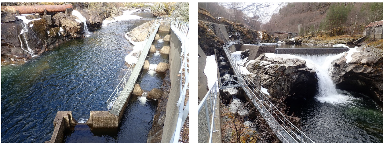
Figur 16: Fisketrappa i Kolgrytefoss med inngangen (venstre bilde) og den øvre delen med betongdammen (Foto: S. Stranzel, NORCE).
