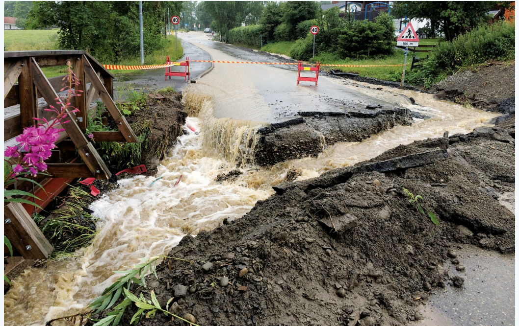
Regnvann på avveie kan gjøre stor skade.
