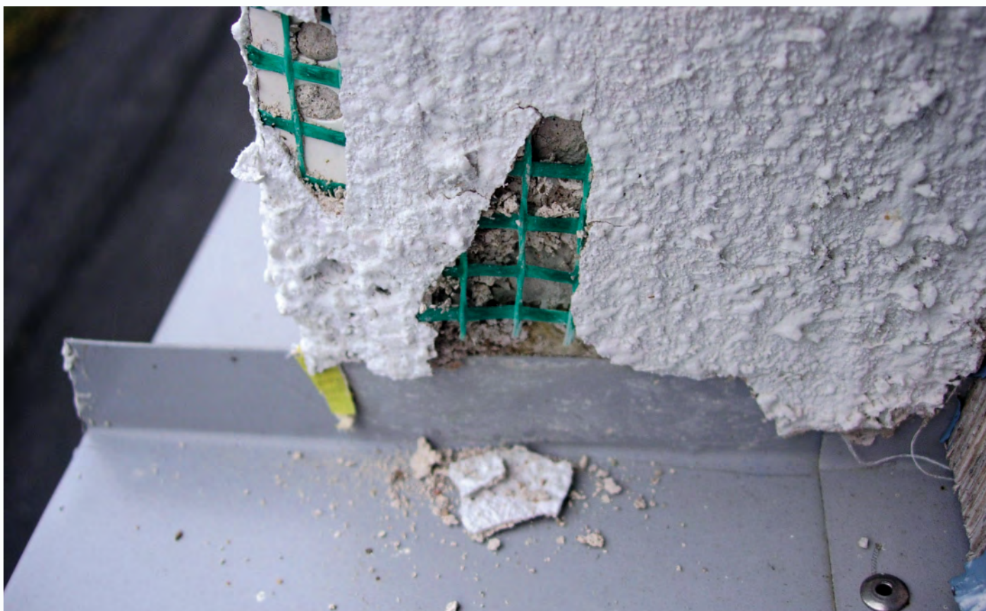
Mange pusskader kunne vært unngått med økt kompetanse. SINTEF jobber med sertifisering for utførelse av pussystemer.
