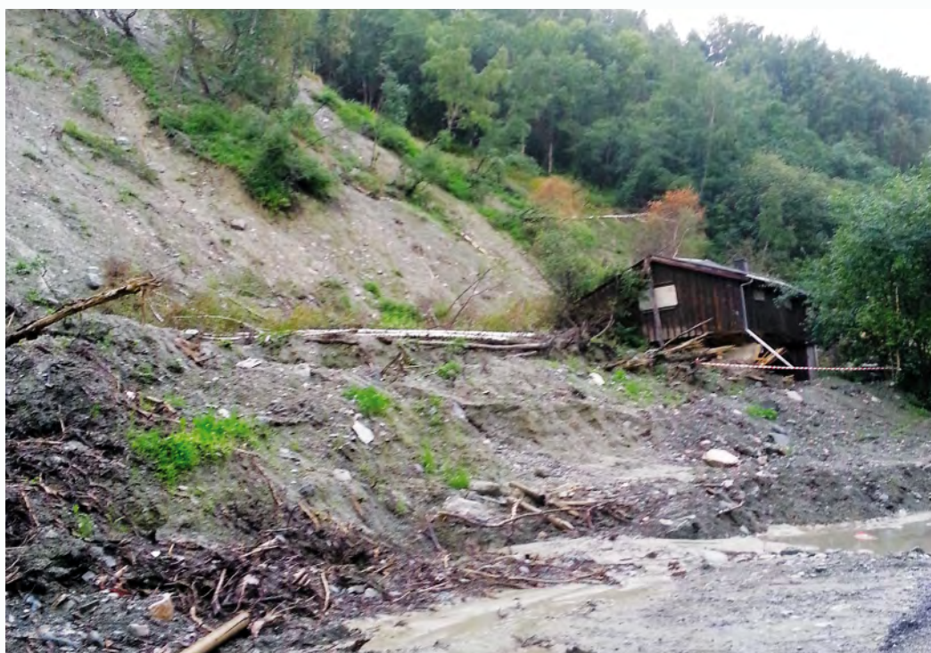
Løsmasseskred utløst av kraftig nedbør, Kvam i Nord-Fron kommune. Skredet har flyttet huset omtrent halvannen meter ut fra grunnmuren. Foto: SINTEF/Byggforskserien
