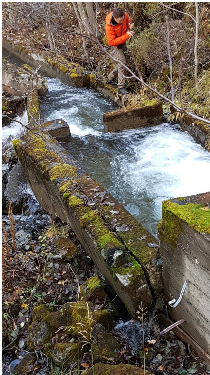
Figur 6. Ovenfor "akvedukten" har sidevangen i trappa veltet ut og det er store lekkasjer.
