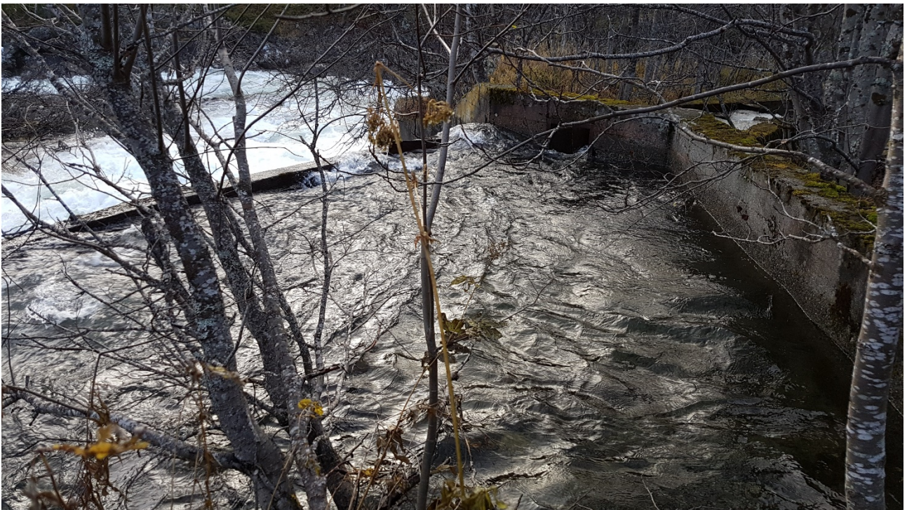
Figur 8. Den øvre delen av trappa i Sagfossen, med dykket åpninger i tersklene og lav sidemur for å redusere trappas vannføring.
