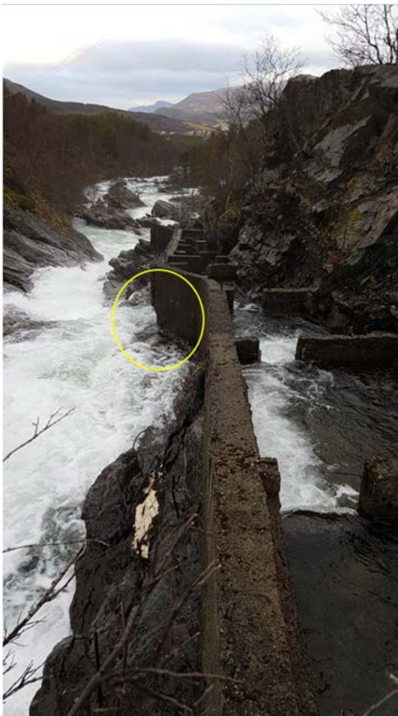
Figur 13. Øvre del av trappa i Mellafossen. Gul sirkel indikerer lekkasjeområdet i underkant av sidevangen.
