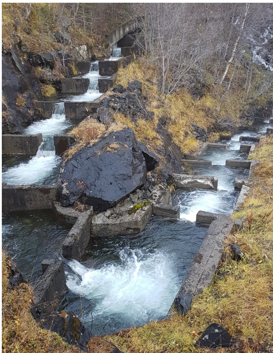
Figur 5. Nedre del av trappa i Sagfossen. Øverst på denne delen dannes en "akvedukt" hvor fisken går under tak. I bakgrunnen skimtes lekkasjevann fra trappas midtre del.
