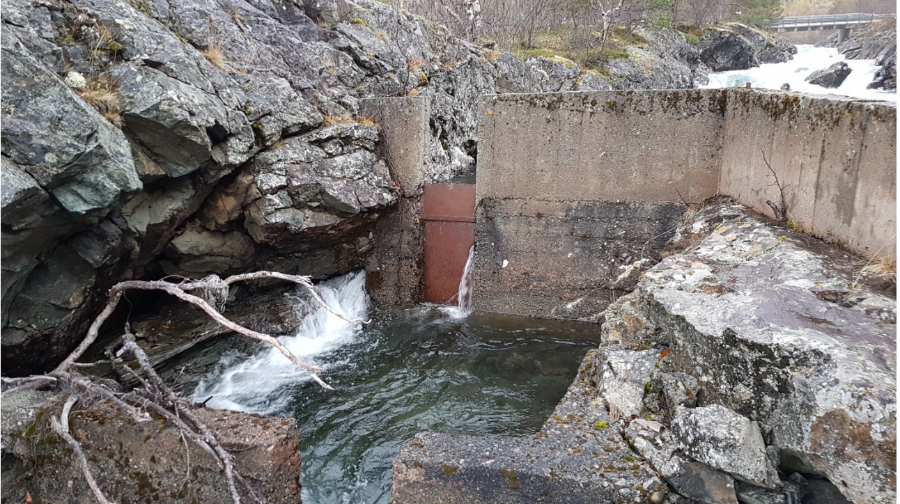
Figur 14. Øvre del av trappa i Mellafossen med vannlekkasje mellom muren og berget.
