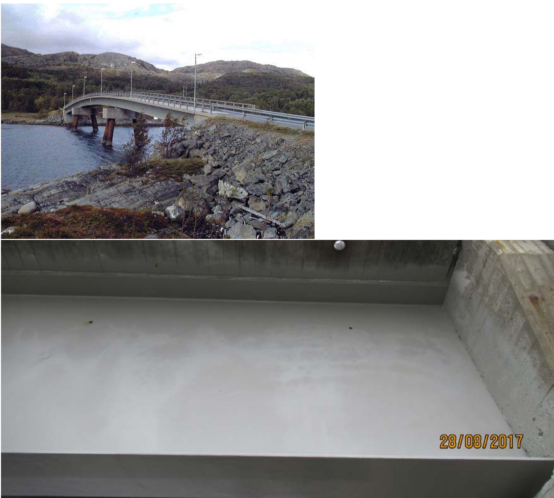
Figur 10. Tilstand til belegget på Madsøybrua
