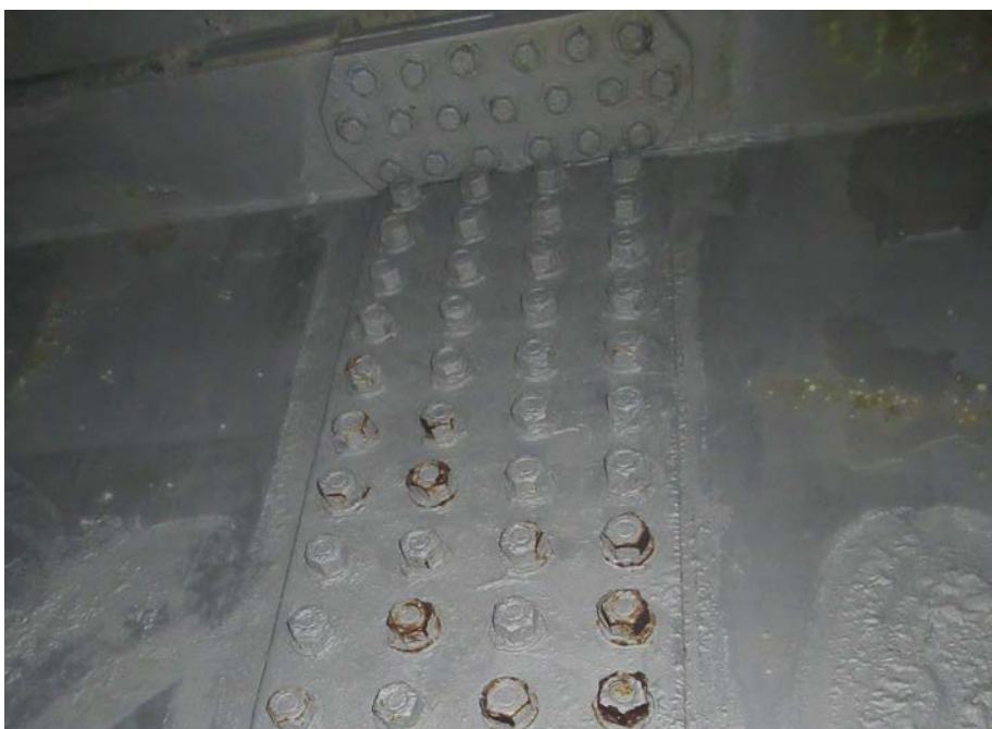
Figur 11. Korrosjon på bolter, samt små angrep av hvitrust på flatene (2017) på Kvalpsundet bru.
