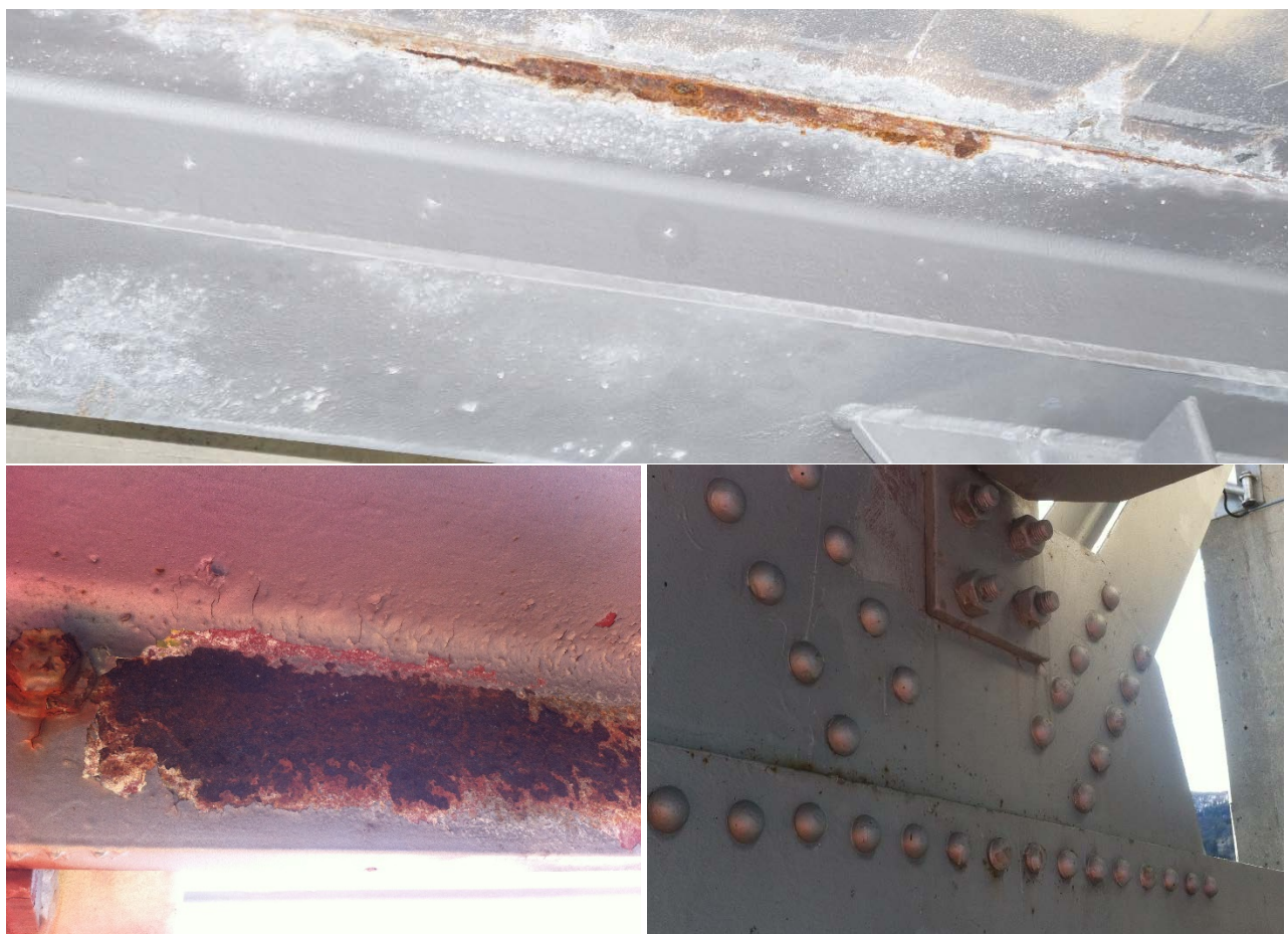
Figur 7. Nedbrytning av belegg på Tjeldsundbrua. De hvite korrosjonsproduktene på det øverste bildet indikerer at bjelken er beskyttet med System 1.
