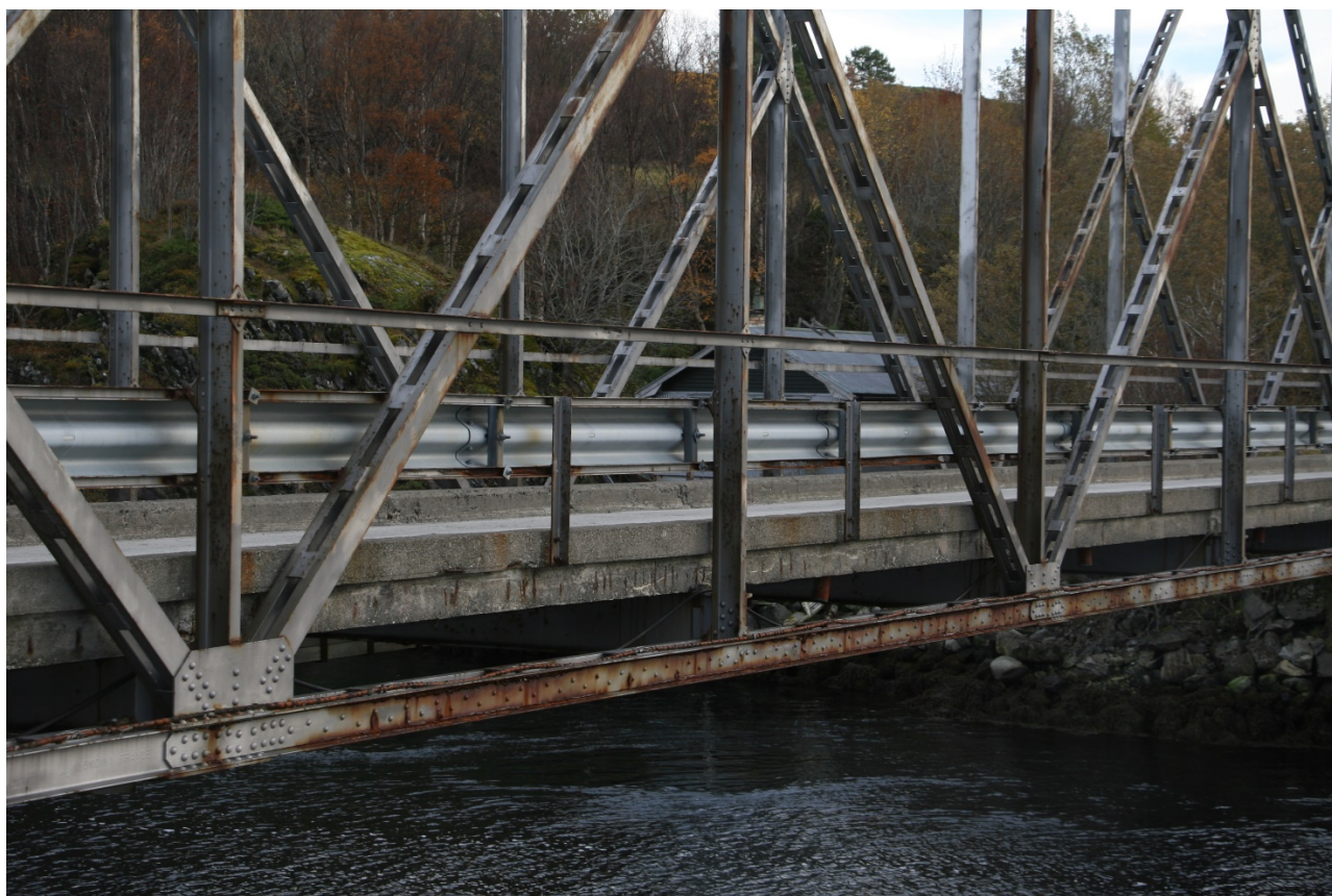
Figur 3. Tilstanden til belegget på Jøssundbrua
