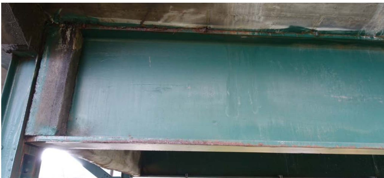
Figur 6. Skader i belegget på bærebjelke
