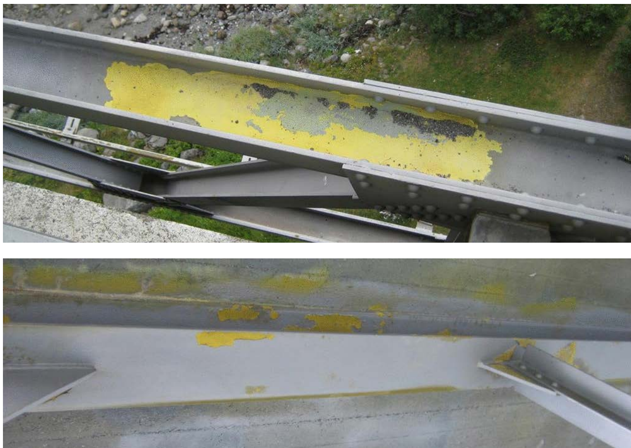
Figur 9. Tilstanden til belegget på Rombaksbrua før vedlikehold i 2011.
