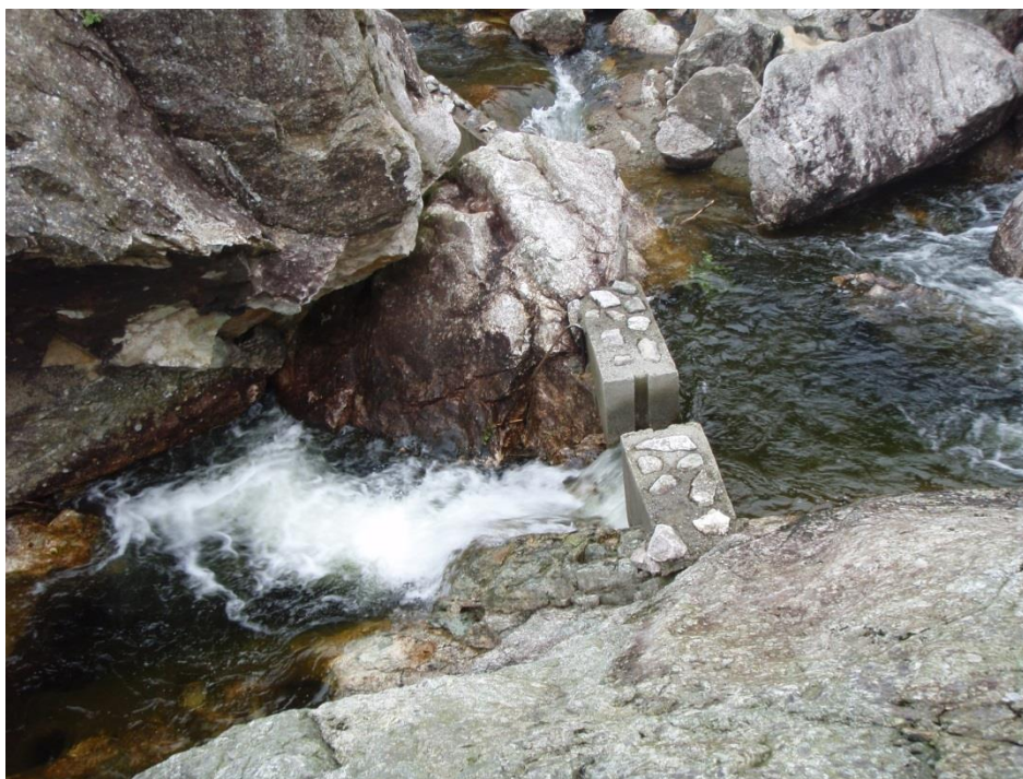
Figur 13. Laksetrappa i Logsfossen. Fisken kan vandre opp ei renne inntil berget på østre breidd. Vandringskorridoren er en blanding av steinblokker og støpte terskler, og vannet renner delvis innimellom steinblokker. Tersklene er delvis ødelagt, og reparasjoner og ombygginger er nødvendig flere steder.
