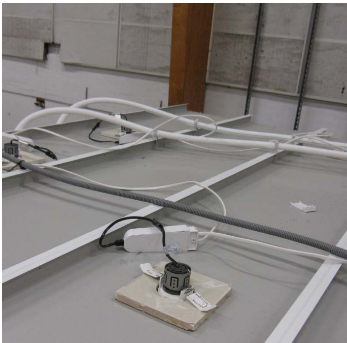
Figur 12 Eksempel på føring fra fordelerskap til tappepunkt over tak Ikke god klamring av bend
