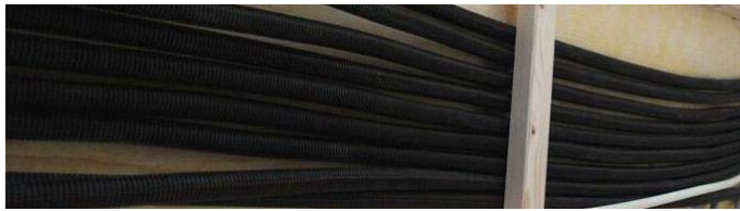
Figur 2 Tappevannsrør ført i himling uten klammer
