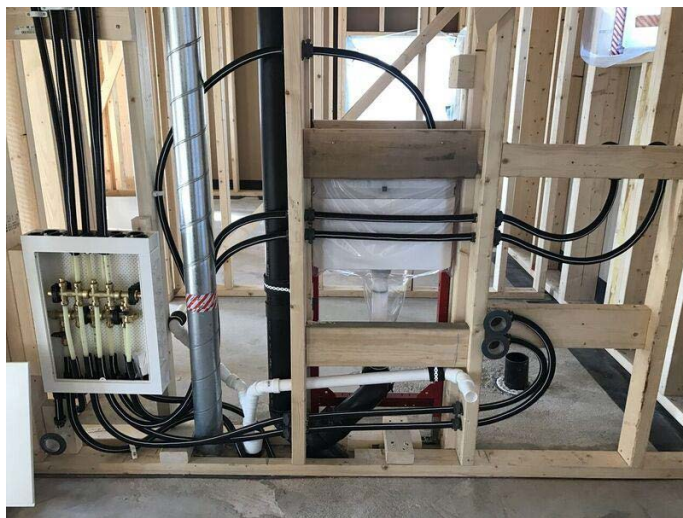
Figur 8 Rør fra fordelerskap til tappepunkter
