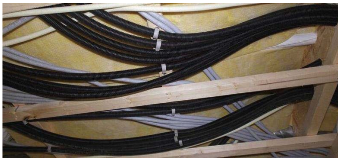
Figur 3 Lange rørstrekk ført i himling med mangelfull klamring
