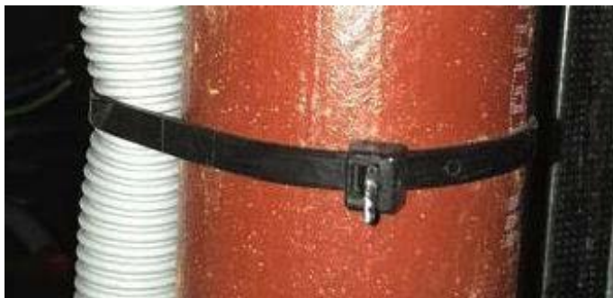
Figur 4 Tappevannsrør presset inntil avløpsrør med strip.
