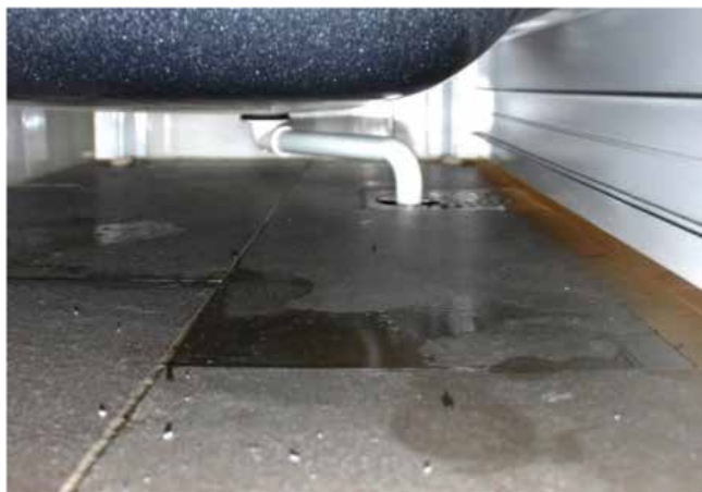
Figur 9: Under løststående badekar kan samles mye vann om ikke det er fall. God avrenning bort fra vegg og på skjulte flater er nødvendig så vannet ikke samles i svanker.
