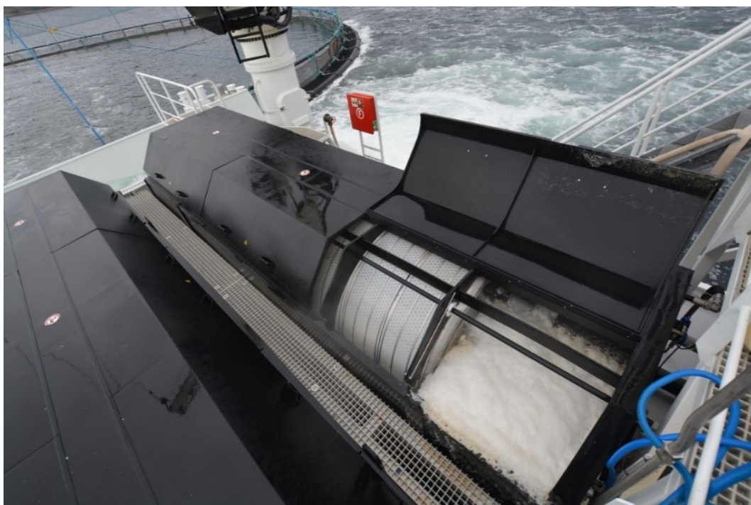
Figur 9 – Hydrolicer LG9332 Hydro: tre parallelle trommelfiltre fjerner partikulært materiale og lus fra prosessvannet før utlipp til sjø.
