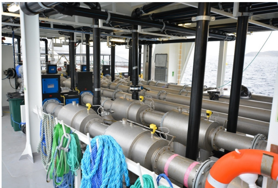
Figur 8 - Bildet viser to seriekoblede enheter (nærmeste rørgate) for avlusing på hydrolicerens dekk. Som vist har Hydrolicer LG9332 Hydro seks parallelle rørgater.
