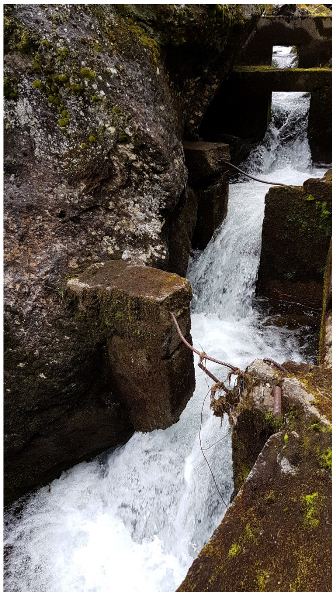
Figur 12. Tersklene i den øvre delen av trappa i Øverfossen er ødelagte
