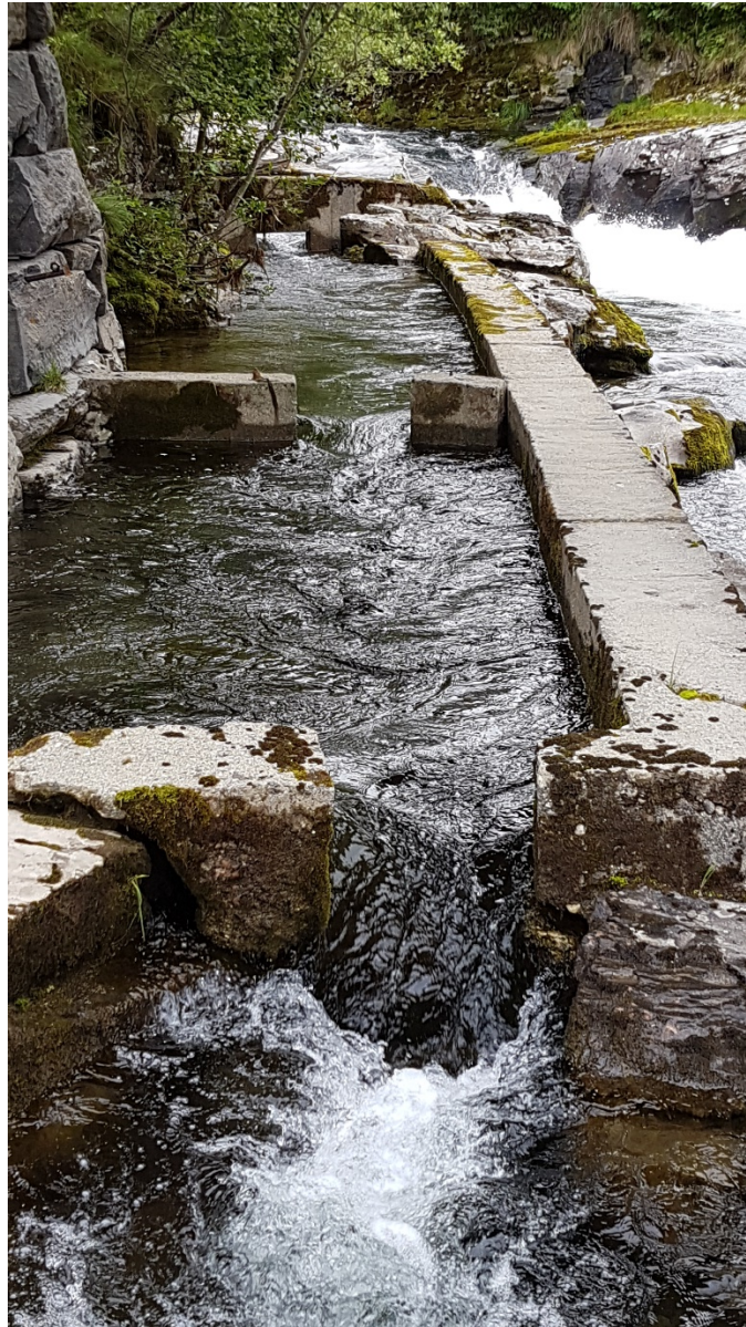
Figur 7. Den øvre delen av trappa i Brufossen, med dykkede åpninger i tersklene og lav sidemur for å redusere trappas vannføring.
