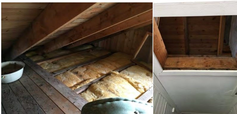
Huset i Gamvik har sperretak, kaldt loft og isolasjon mellom bjelkene. Med åpen takluke ser man at det er flere lag papp i himlingen.
