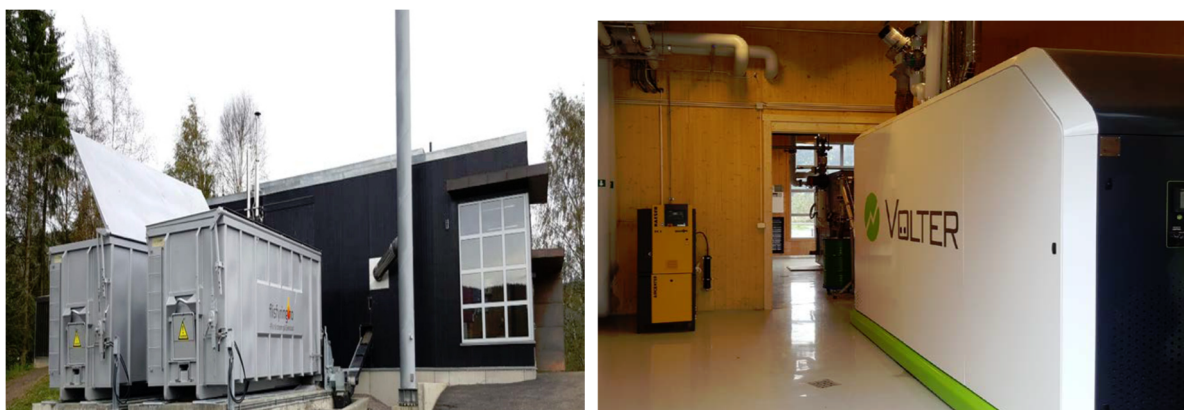
Figur 4.17. Kombinert kraft- og varmeproduksjon (CHP) tilknyttet på Campus Evenstad. Foto: ETA Norge og Statsbygg [6]
