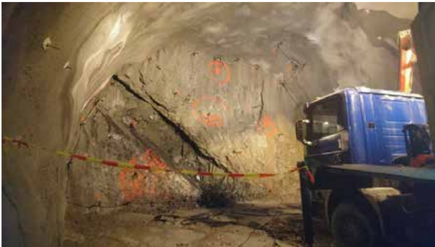
Figur 10 Utfall av forvitret bergmasse fra gabbrogang pel nr. 13297 (13. mai)
