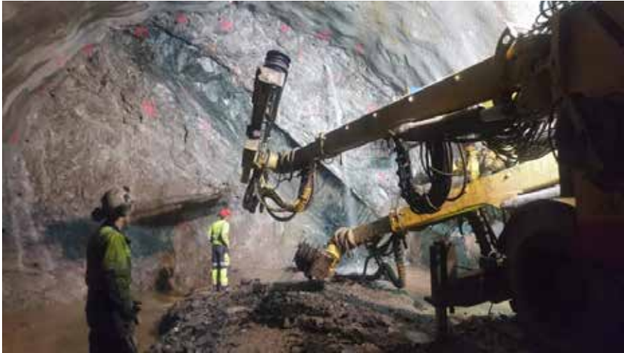
Figur 13 Mye lekkasje i avlastningshull på høyre side
