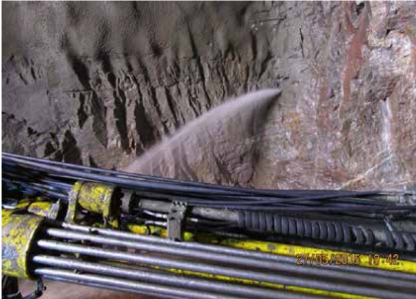
Figur 9 Eksempel på innlekkasje påtruffet ved pel nr. 14914
