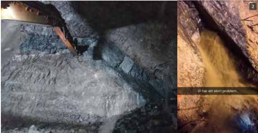
Figur 11 Pigging etter opprettingssalve ved pel nr. 13292 til venstre. Lekkasje fra gabbrogang til høyre
