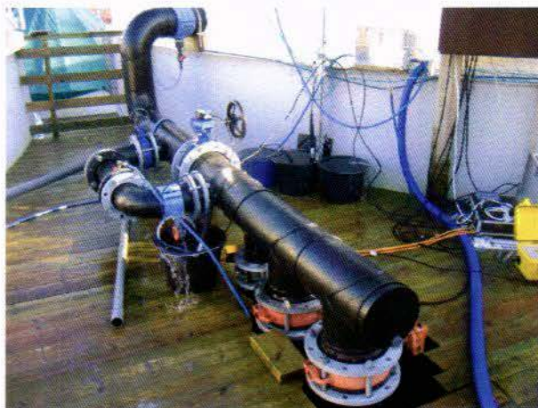
Figur 3. Vann ble ledet til 10 L plastbøtter for måling av O 2 og totalgassmetning (TGP) fra rørgate (råvann) og SOLVOX ® OxyStream (oksygenert vann)
