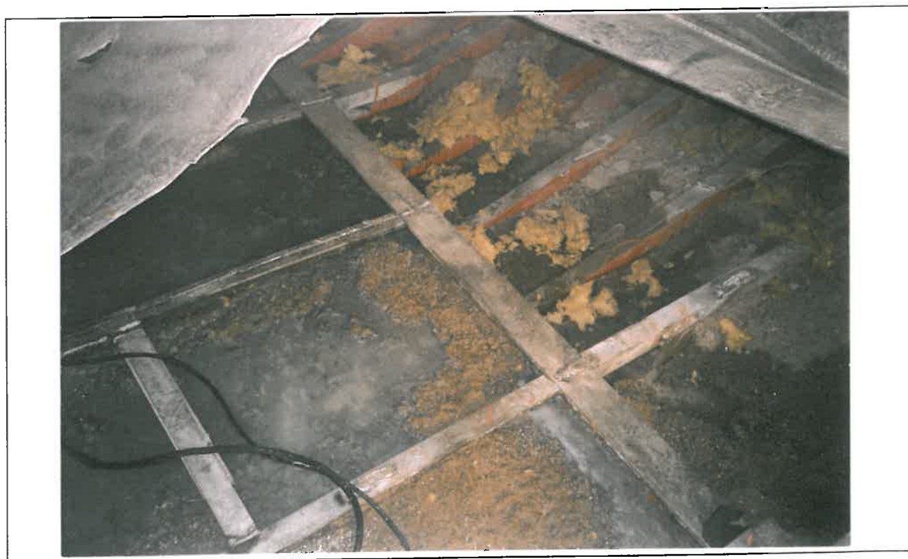
Bilde 16: Fjernet garnering (4 mm plater) i bulkrom på M/S "Solværgutt" etter eksplosjonen ved verksted i Grovfjord, mai 1999. Bildet viser vanddammer oppå betongen samt rester av våt steinull.
