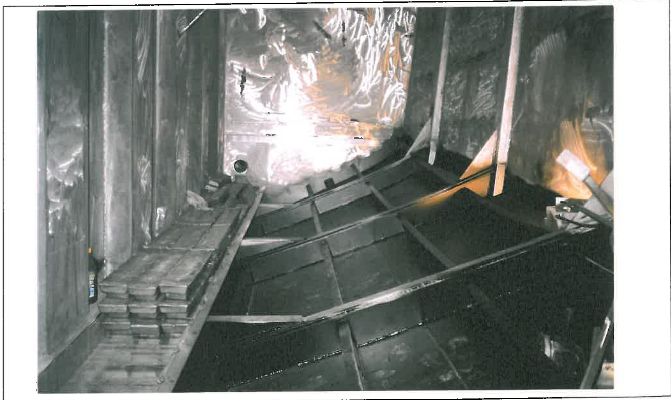
Bilde 12: Forberedelser for innlegging av fast ballast (blybarrer og betong) i siderom på M/S "Korsnesfisk" av Båtsfjord, bygg nr. 190 ved Saltdalsverftet på Rognan, desember 1998. Samlet mengde fast ballast anslått til ca. 44 tonn betong og 10 tonn blybarrer, sum 54 tonn.
