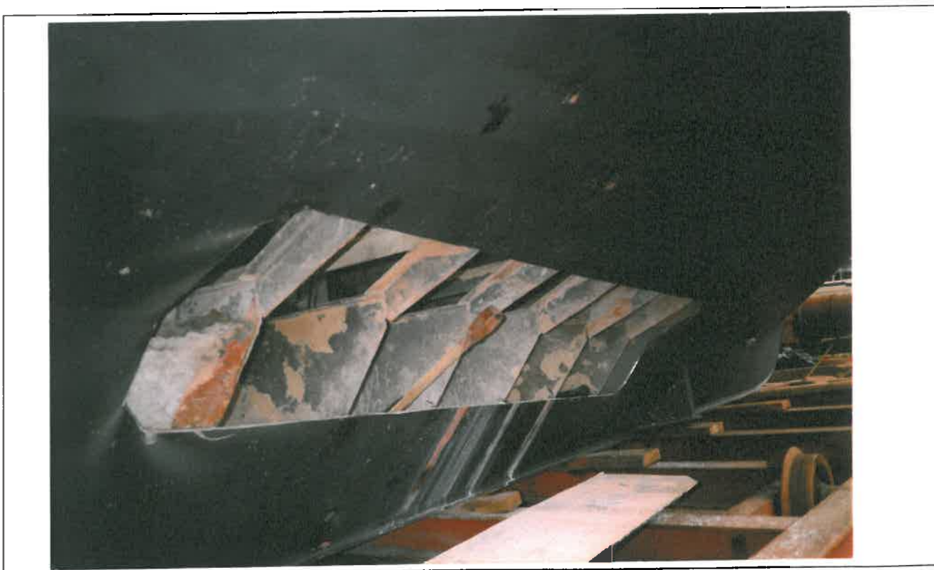
Bilde 10: Tømming av betongballast på M/S "Arnøyfjord" NT-100-NR (Nærøy), bygg nr. 65 ved Solnes Båt AS, levert 1992. Tæringskader i bunnparti under bulkrom oppdaget og reparert i 1996.
