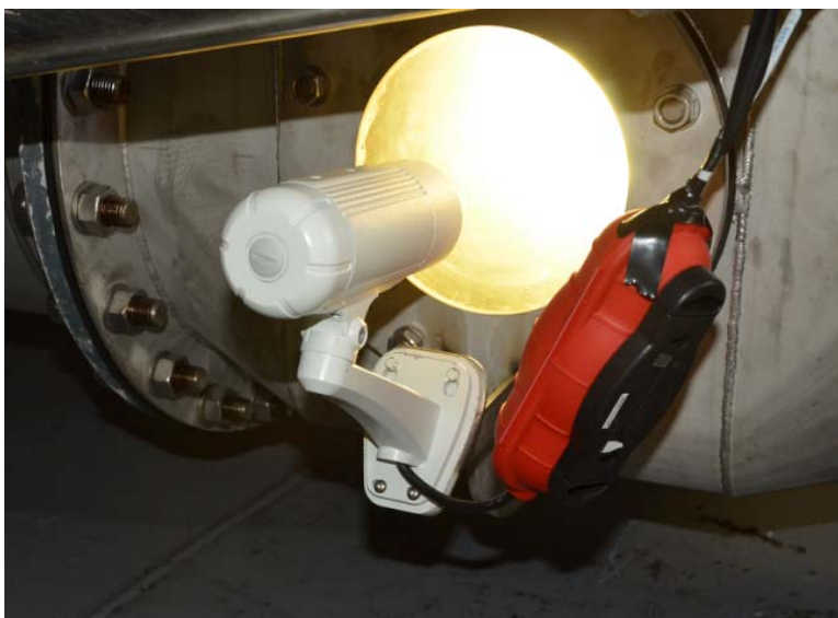
Figur 6-7: Vivotek IP8335H nettverkskamera montert på pumperøret og vindu med bakbelysning.
