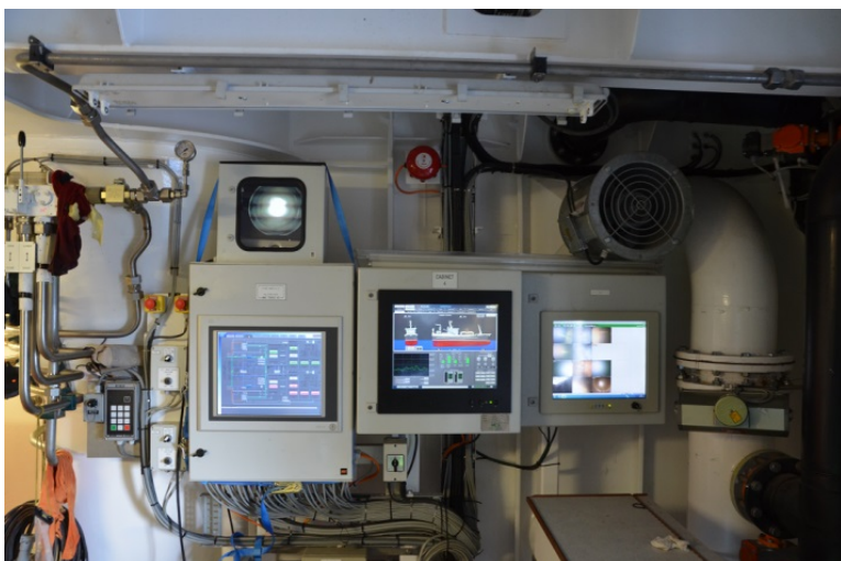
Figur 6-8: Skap med skjerm og datamaskin som viser videobilde fra kamera på pumperøret montert provisorisk oppe på eksisterende styreskap.
