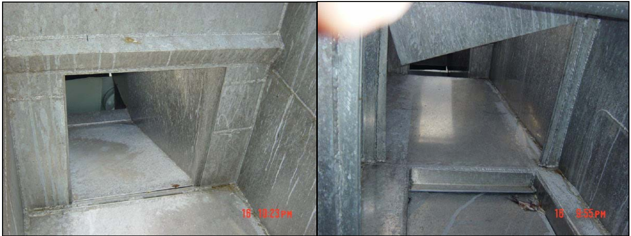
Bilde 6 Innside av fordelingskasser. Vi ser flere skarpe kanter og plater som står 90° i forhold til fartsretningen til fisken.
