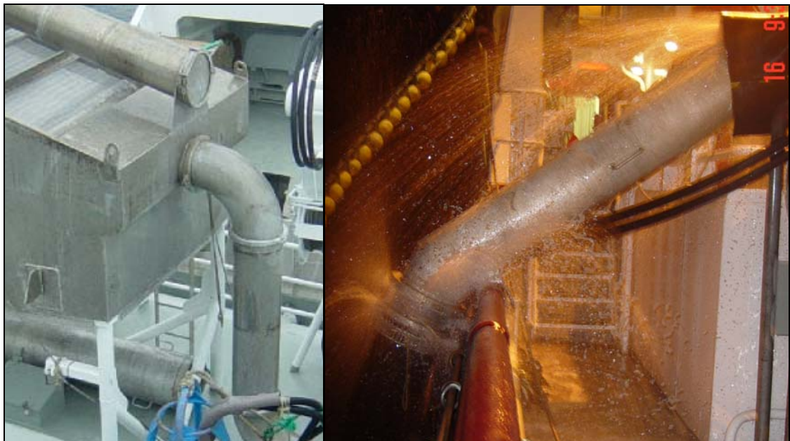
Bilde 7 Rør fra pumpe til silekasse. Bend med både 90° og 45° vinkel
