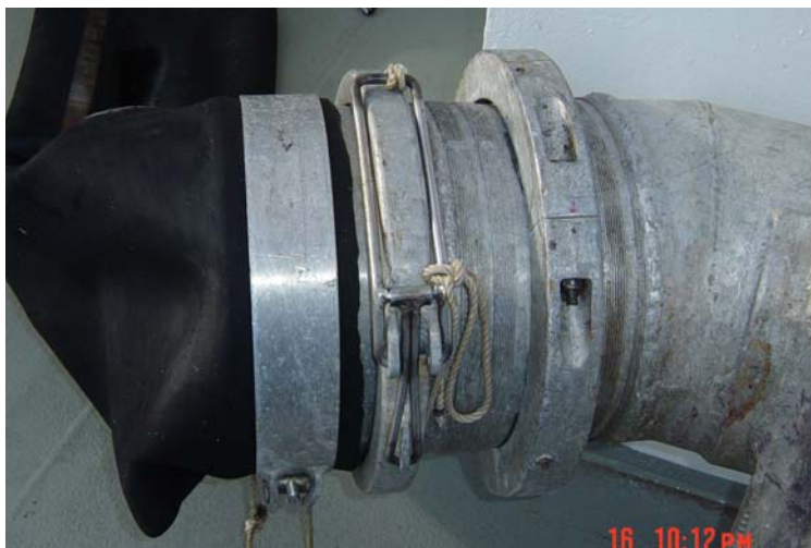
Bilde 8 Skjot mellom gummislange og rør.
