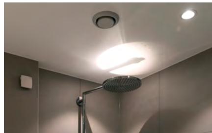
Avtrekk og fuktssensor på baderom.
