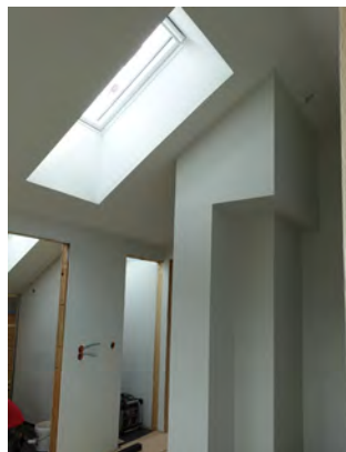
Innebygde ventilasjonskanaler i 2. etg
