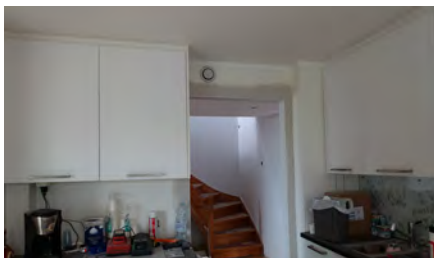
Avtrekk i kjøkken med kanal fra nedfôret himling i gangen
