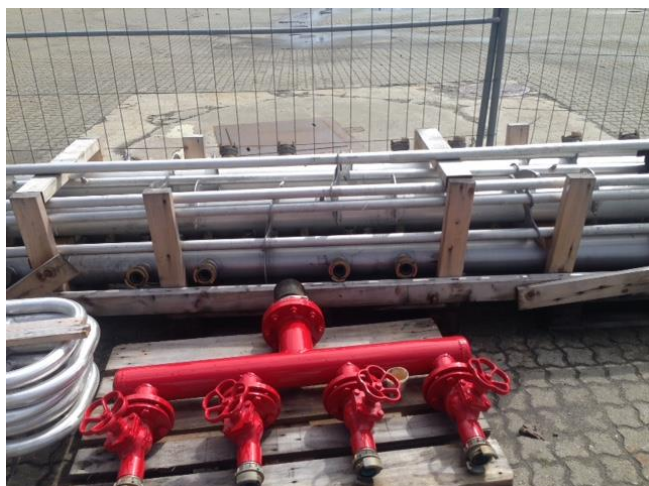
Figur 2.7 Ekstra manifold koplet på ballastpumpe for å øke vannmengden og kapasitet.
