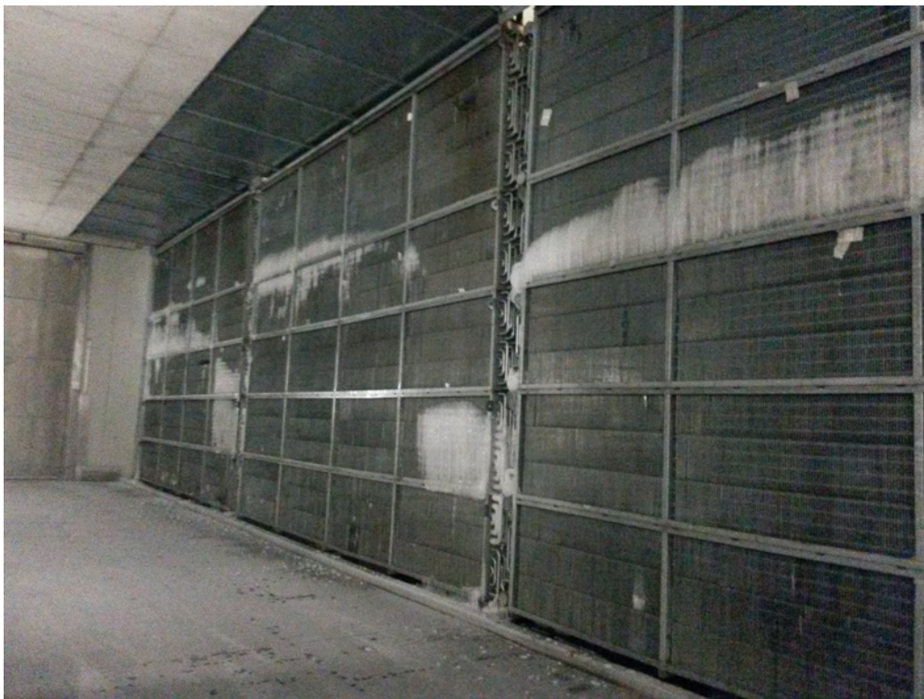
Figur 7.10 Is på fordampere i tunnel 3 før avriming.
