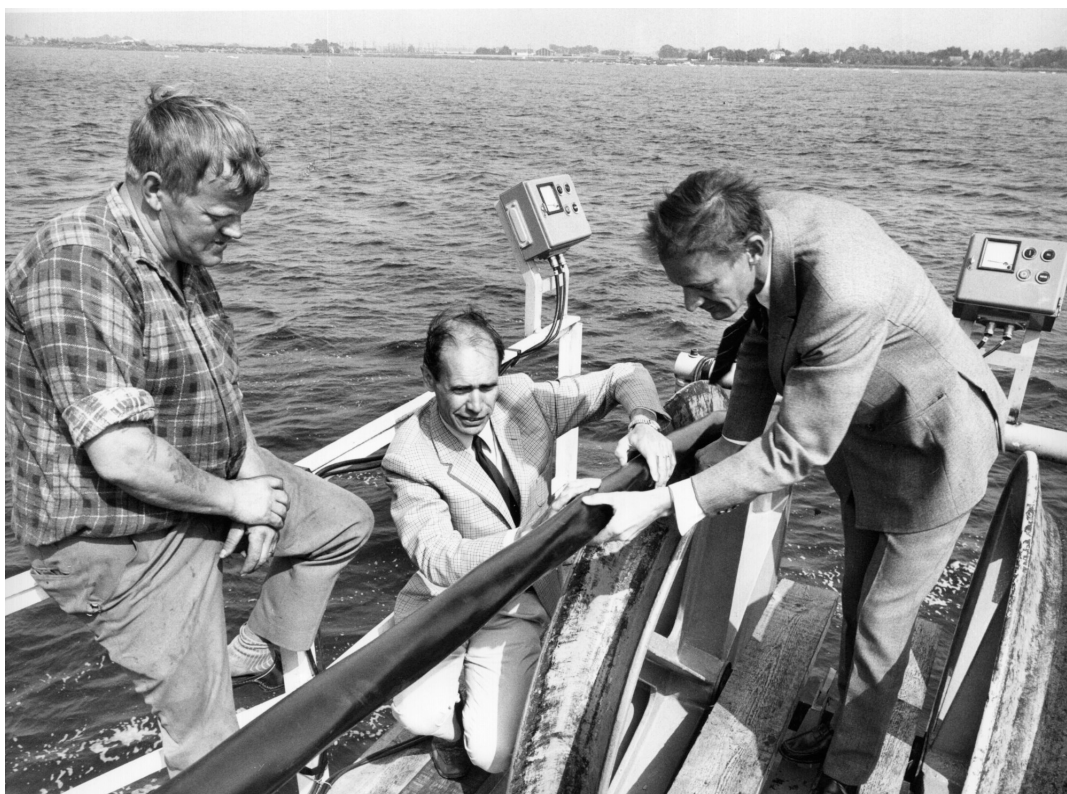
Förläggning av en 20 kV sjökabel i Höllviken till Skanör. Det var en av de första plastisolerade kablarna. Lennart Elg som står till höger var vår kabelspecialist på den tiden.
