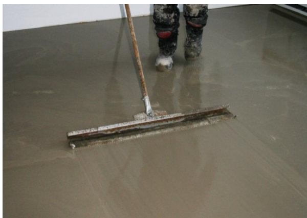
Figur 4a og b: Selvutjevne golvavretningsmasser ble blandet og lagt utover, klar til flislegging.
