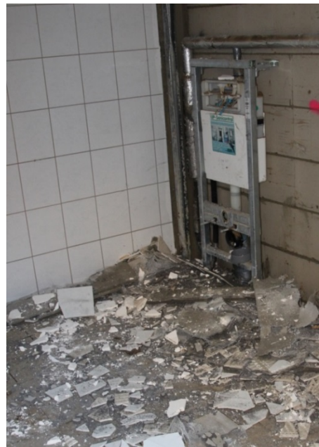
Figur 2: Den fuktømfintlige gipsplateveggen til høyre hadde ikke tålt påkjenninger og måtte rives.
