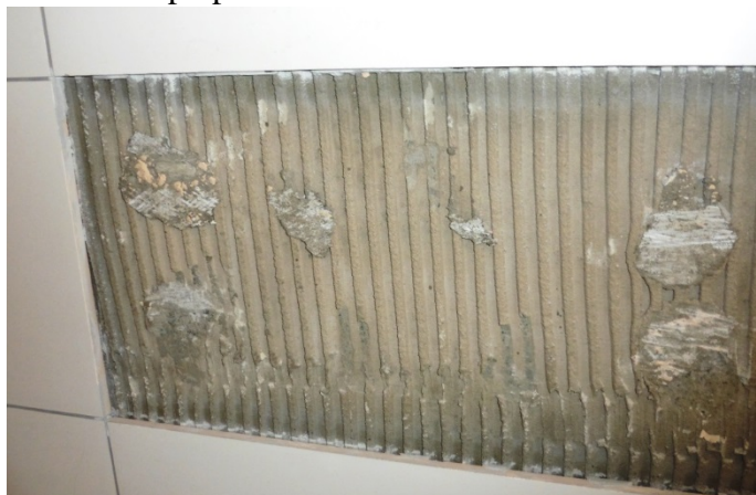
Figur 3: Punktliming medfører store områder med manglende vedheft og hulrom for mye fukt bak flisene.
