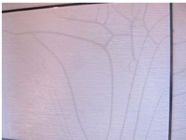
Figur 2: Tykke limlag kan i verste fall medføre krakeleringer i flisglasuren.
