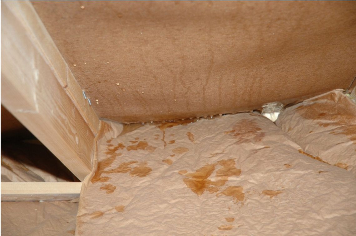
Foto 3 Kondensdannelse på undertak
