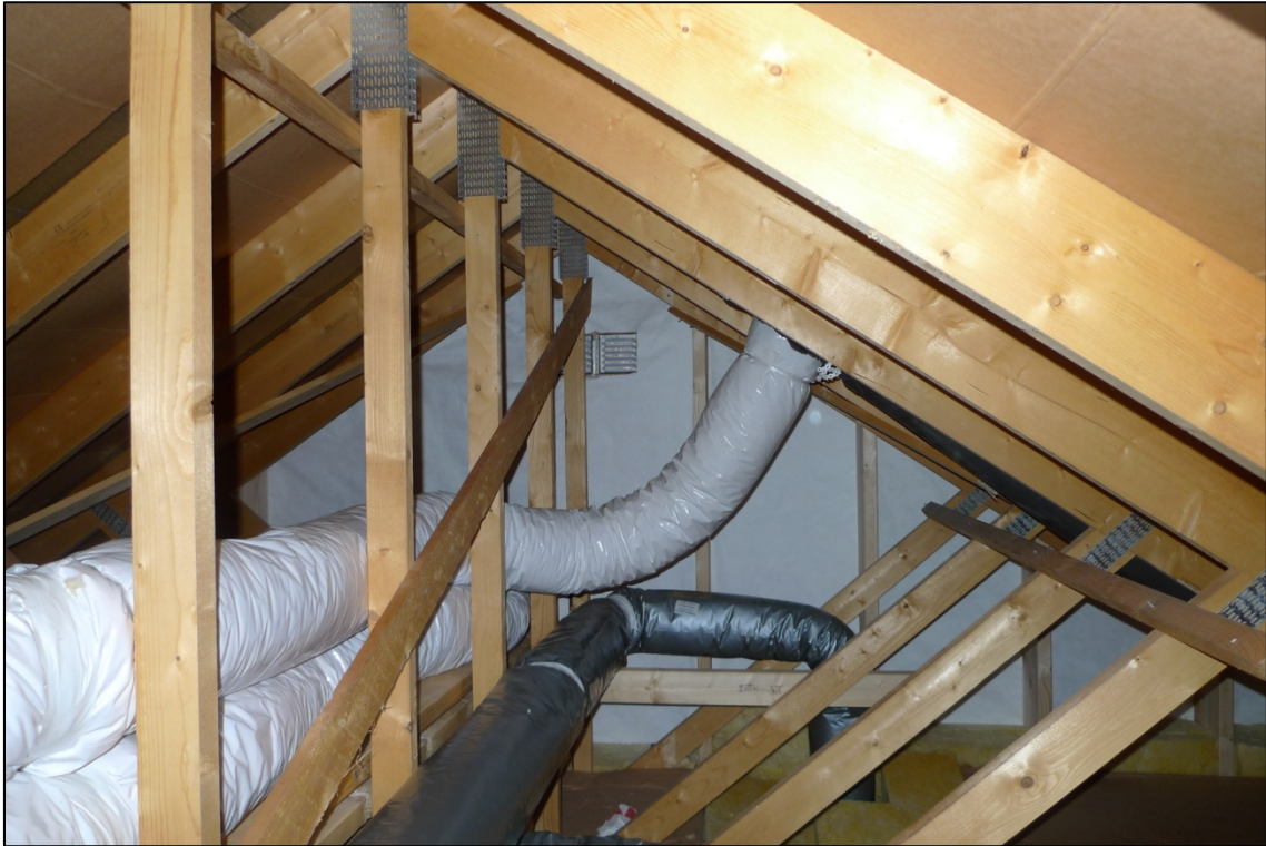
Foto 7 Ventilasjonskanaler på kaldt loft
