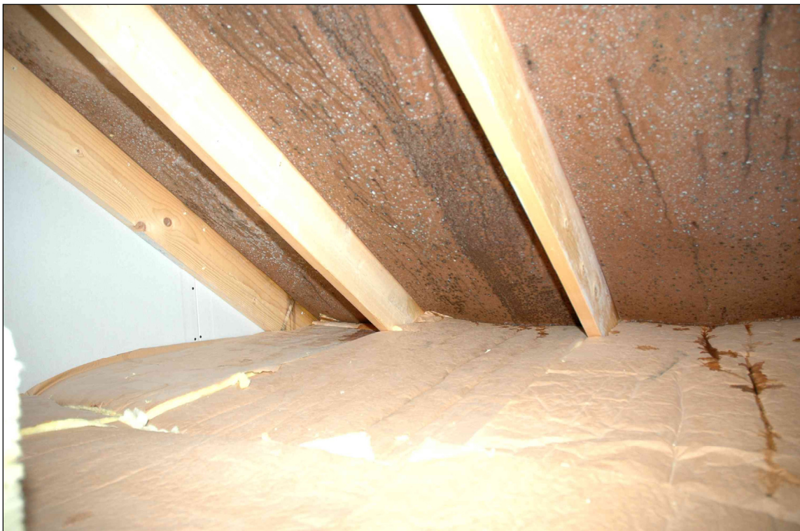
Foto 2 Mugg- og kondensdannelse på undertak
