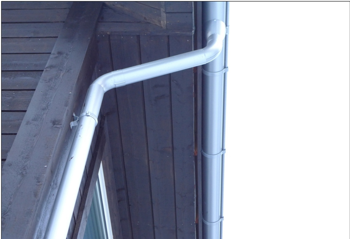
Foto 4 10 mm luftspalte i bak forkantbord
