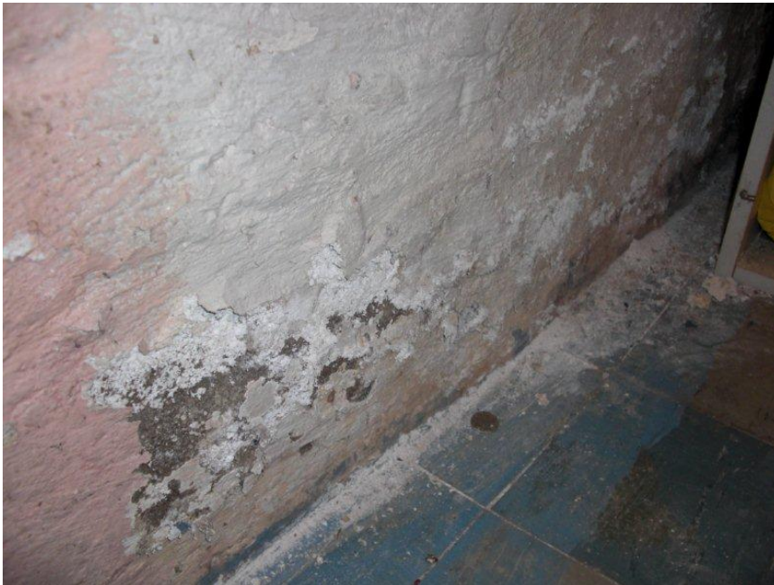
Fig. 1.1.4 Eksempel på saltutslag. Her har krystalliseringen skjedd bak et tett malingslag som skaller av sammen med pussen på grunn av volumøkningen. Vi ser maling og pussrester på golvet rett under. Foto: SINTEF Byggforsk
