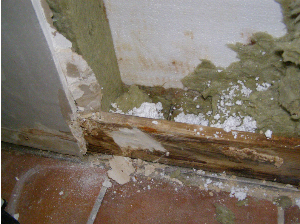
Fig. 1.2.4 Råteskadet spikerslag i innvendig utforing ned mot golv. Skaden skyldes lekkasje gjennom veggen utenfra. Det er ikke benyttet plastfolie i dette tilfellet så uttørkingsmulighetene er relativt gode – men ikke gode nok. Foto: SINTEF Byggforsk
