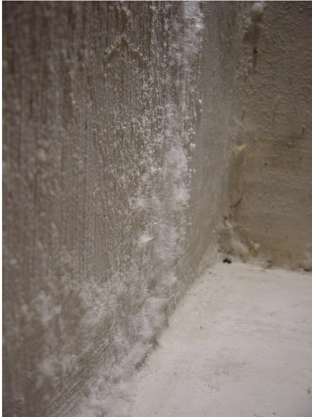
Fig.1.1.3 Eksempel på saltutslag. Saltene har dannet krystaller på overflaten på en ubehandlet betongflate. Foto: SINTEF Byggforsk
