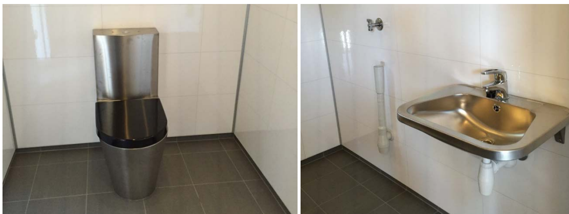
Figur 45 og 46. Klosett og servant, Mælabakken boligpilot. Foto: SINTEF Byggforsk
