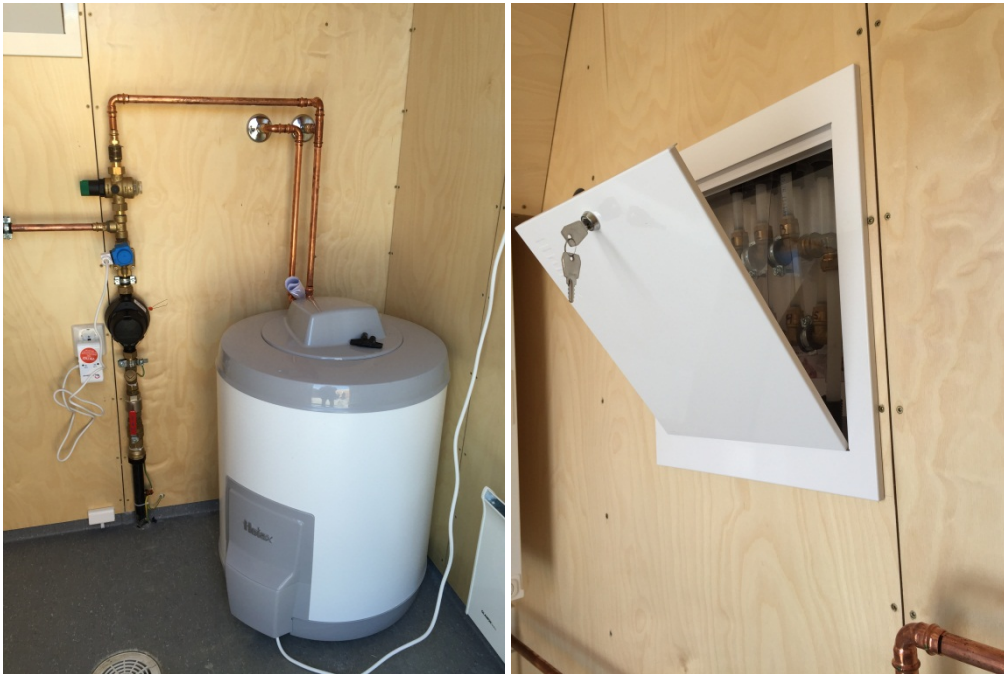
Figur 38 og 39. Teknisk rom med sikringsskap, Mælabbakken pilotbygg. Foto: SINTEF Byggforsk
