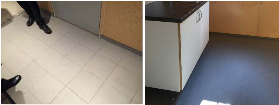
Figur 28 og 29. Flisgulv med epoksyfuger (til venstre) og vinylgulv (til høyre). Fra Mælabakken. Foto: SINTEF Byggforsk
