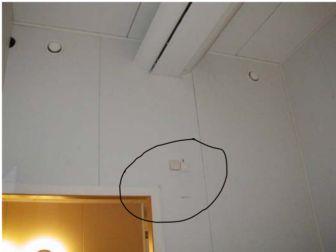
Figur B-11. Plassering av termostat og bevegelsessensor over døren på vegg mot korridor - Cellekontor (Foto: SINTEF Byggforsk/ Catherine Grini)
