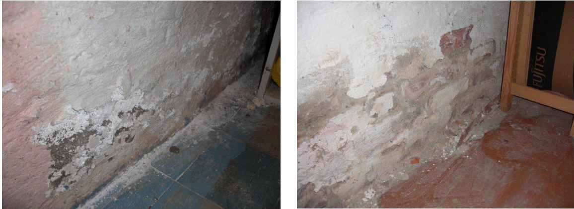
Fig. 2.3.2 Eksempler på skader på innvendig overflate i kjelleren på grunn av inntrengende fukt utenfra.
