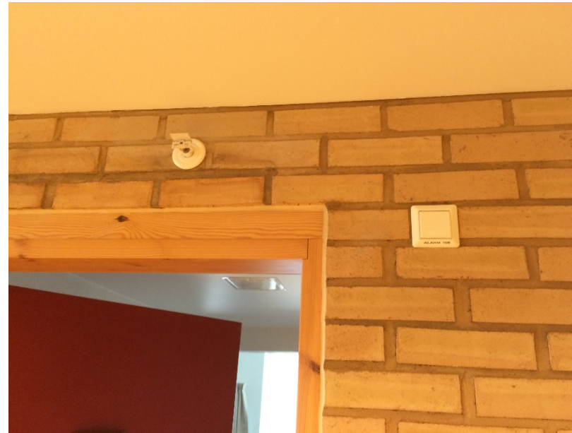
Aktiveringsknapp for vandrealarm på utsiden av beboerleilighet – eksisterende alarm
