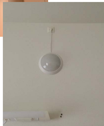
Egen lampe på vegg kontrolleres av bevegelse i rom
