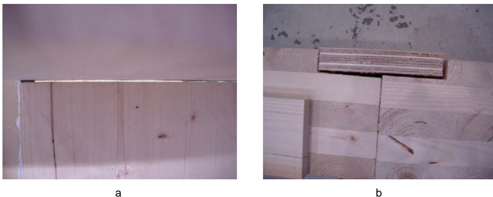
Figur 8.1 Eksempler på unøyaktigheter i massivtreelementene. Høydeforskjell på veggelementene gir glipe mellom vegg- og gulvelementene (a). Unøyaktig utfresingen i skjøten mellom gulvelementene gjør at dekkbordet i skjøten gir dårlig lufttetting (b).
