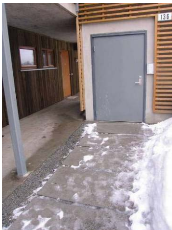
Overgang i grus mellom betongheller og støpt betong i svalgang – hindring for rullestolbruker
