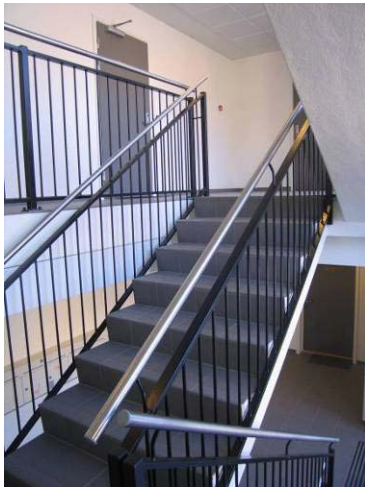
Håndløper i kontrast, men ingen markering av trinnene
