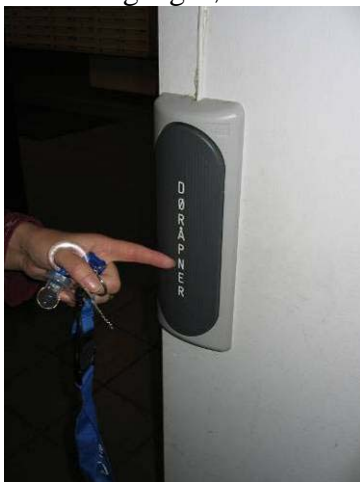
Automatisk døråpner ved hovedinngang
