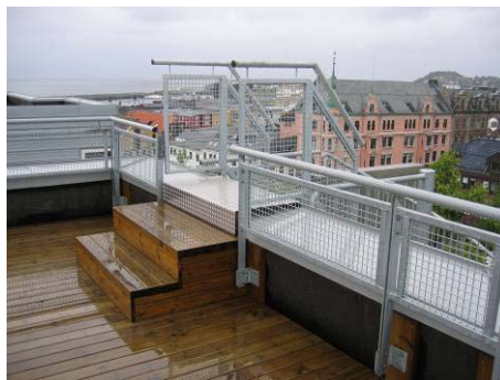
Rømning via branntrapp
