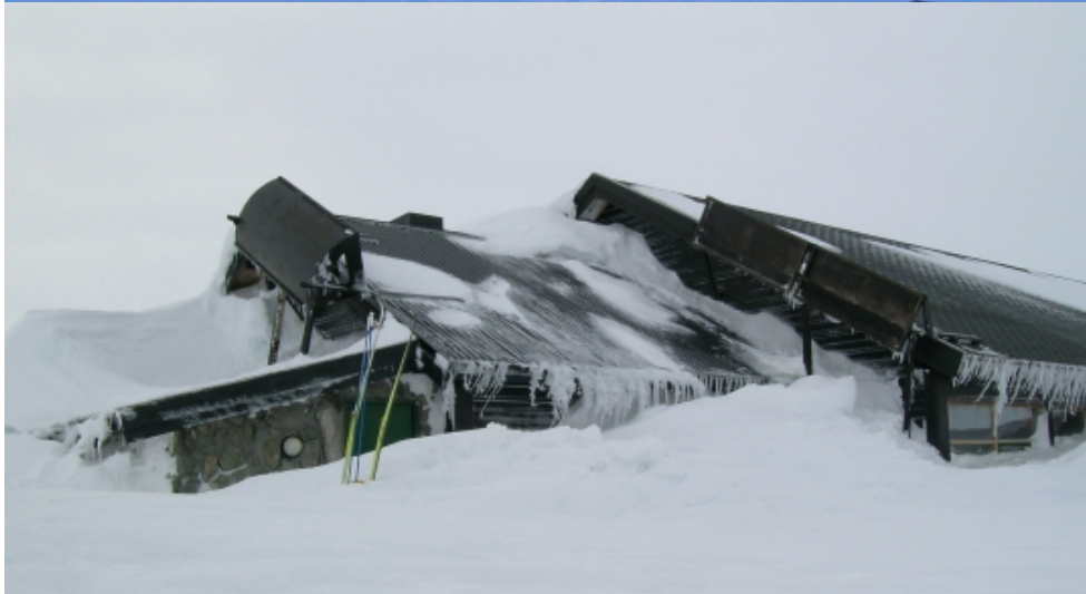
Figur 4.4.2.3 Snøspylar fjerner snøfonner i lesoner. Vindretning fra høyre. Foto: Byggforsk
