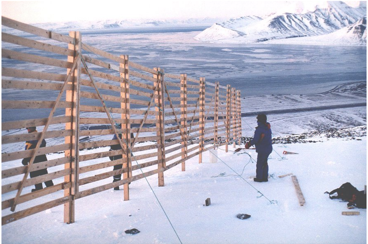
Figur 4.4.1.3 Oppsetting av en 50 % tett snøskjerm på Svalbard. Foto: Byggforsk
