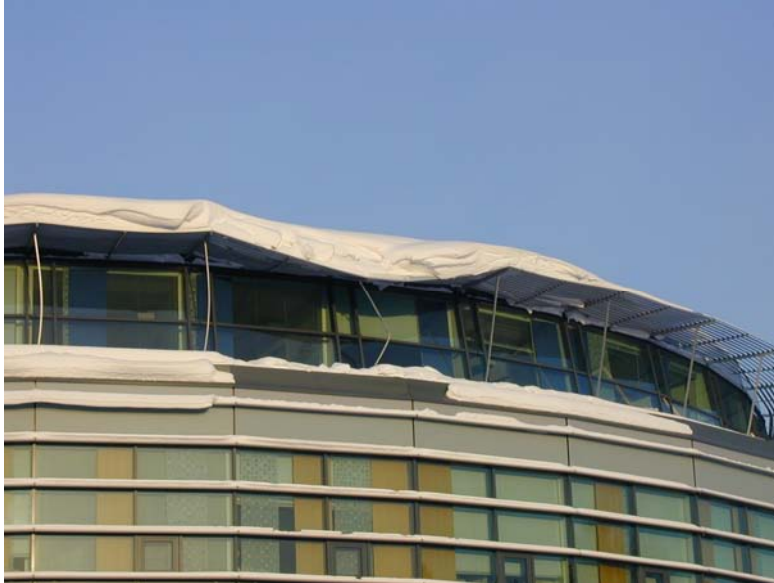
Figur 3.3.3 Lesonefonn som har lagt seg på solavskjermingen på en bygning i Oslo. Foto: Byggforsk
