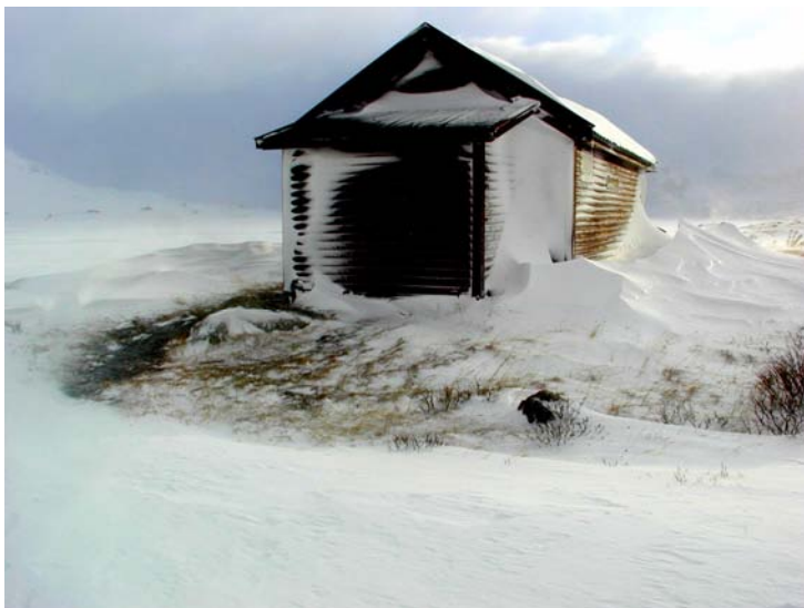
Figur 3.2.2.2 Fjellhytte med lefonn, lofonn og sidefonn, vindretning fra venstre (Finse, Hordaland). Foto: Byggforsk
