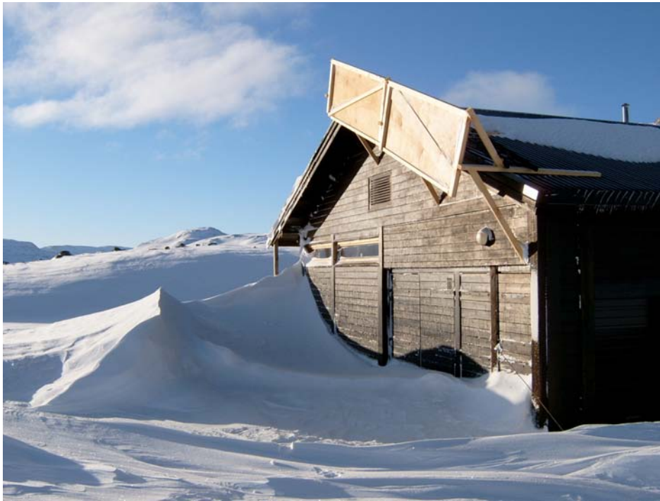
Figur 4.4.2.4 En snøspylers kan fjerne snøfonna foran garasjeporten. Vindretning fra høyre i bildet. Foto: Byggforsk
