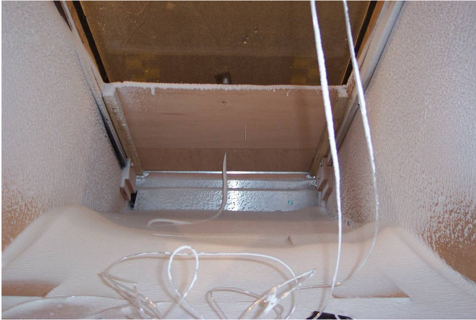
Figur 25 Utfelt snø inne på kaldt luftet loft, seksjon B.
