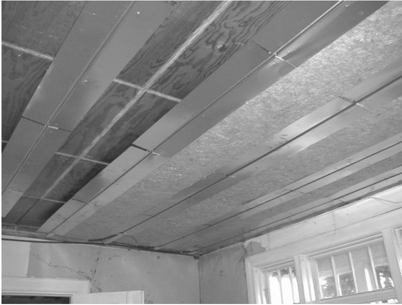
Fig. 3.8. Isolasjonen i hulrommet over sekundærlektene holdes på plass av varmfordelingsplatene for varmerørne.
