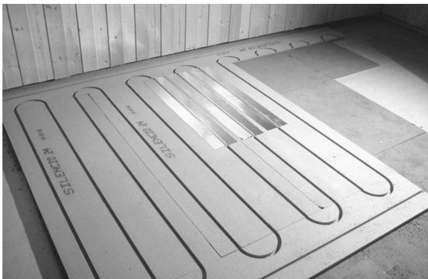
Fig. 3.3. Lett gulvvarmeutførelse med tung mineralullisolasjon (300 kg/m 3 ) som trinnlydis- og tilleggsisolasjon og 24 mm porøse trefiberplater med spor for varmefordelingsplater i mellombjelkelag. Konstruksjonen er godt egnet både i ny og eksisterende bebyggelse og kan også brukes mot kald kjeller.
