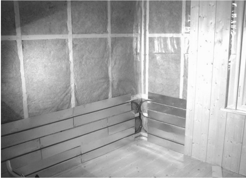
Fig. 3.5. Eksempel på veggvarmeanlegg der varmfordelingsplatene er montert til lektene etter metode b i fig 3.4.
