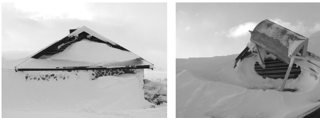
Figur 17 Akkumulasjonsområde før (til venstre) og etter (til høyre) installasjon av snøspylar IV (foto: T. Thiis, NBI)
