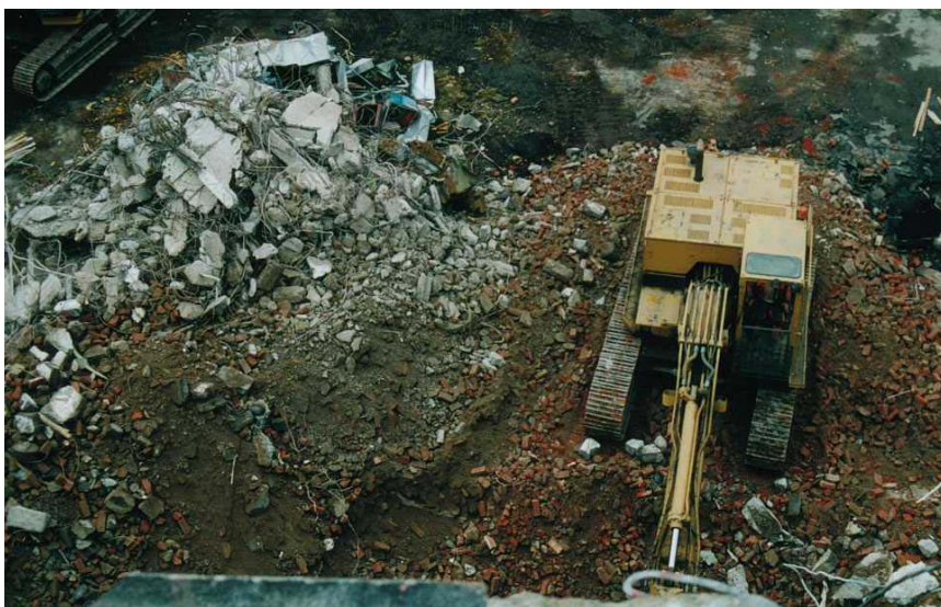
Figur 6 Tegl og betong ble etter riving skilt ved maskinell sortering så langt det lot seg gjøre.
