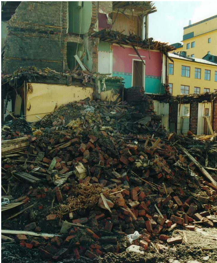
Figur 3 Innvendige vegger var utført med trevirke, og en del stenderverk i trevirke medførte også at teglmassene inneholdt mye trevirke ved riving.
