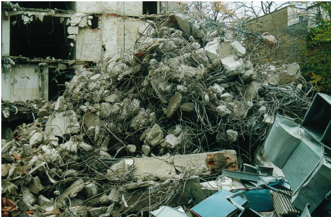
Figur 7 Etter grovsortering og nedklipping av større betongklumper fra armeringen, ble massene levert gjenvinningsanlegg for videre nedknusing og materialgjenvinning.
