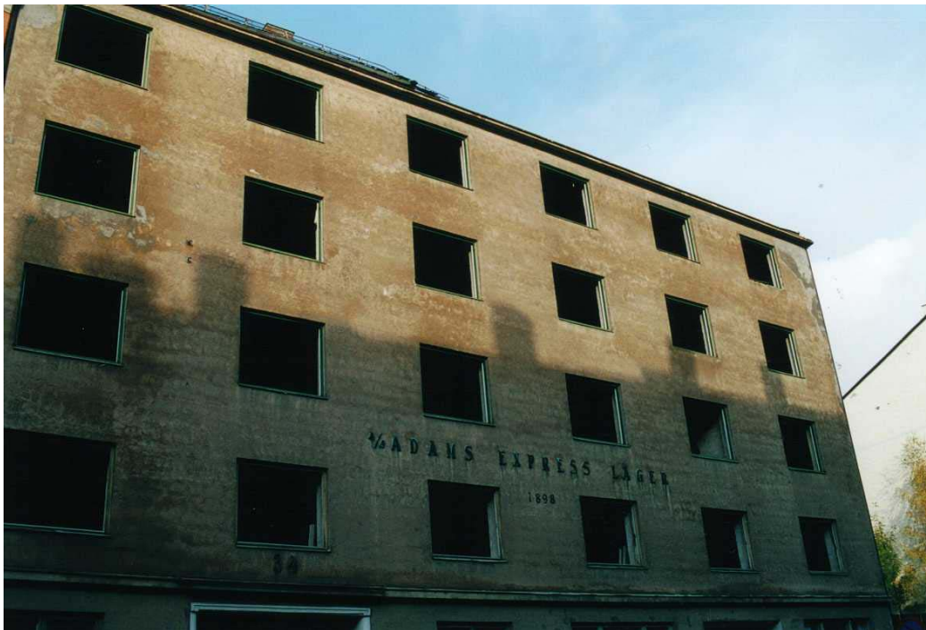
Figur 1 Kontorbygning oppført i plaststøpt betong med teglfasader fra 1928. Bildet er tatt etter gjennomføring av miljøsanering. Vinduene ble tatt ut hele som del av den selektive rivingen.
