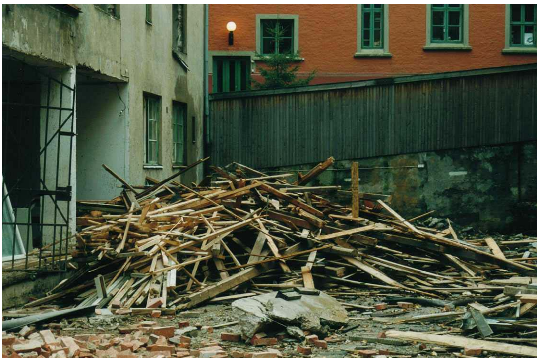
Figur 10 Sortering av trevirke ble gjennomført i bakgården etter hvert som riveprosessen pågikk i etasjene.
