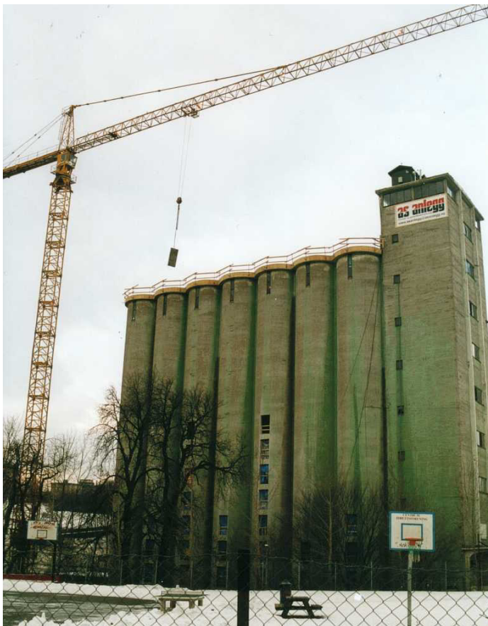
Figur 2 Større betongblokker ble skjært ut som åpninger til vinduer og dører i silocellene. De utskjærte blokkene målte ca 1,2x2m, og ble heist ned til bakkenivå ved hjelp av kran.
