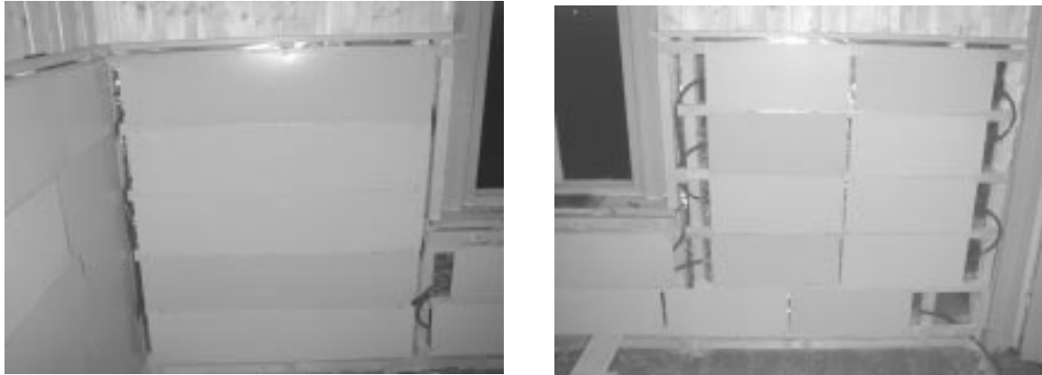
Fig. 7.1.1. Veggvarmeanlegg der vannrørene er festet til Al-klips som er limt til en Al-plate. Varmerørene vil da ligge bak varmfordelingsplatene. Dette kompliserer leggingen ved ettermontering av veggvarmeanlegget, men gir rørene en viss beskyttelse mot skader og gjør at Al-platene kan dekke deler av rørøyene. Alternativt kan man bruke Al-profilplater der varmerørene legges på plass etter at varmfordelingsplatene er montert. Som for gulvvarmeanlegg er det viktig å velge et rørmønster der man unngår rørskjøter.
