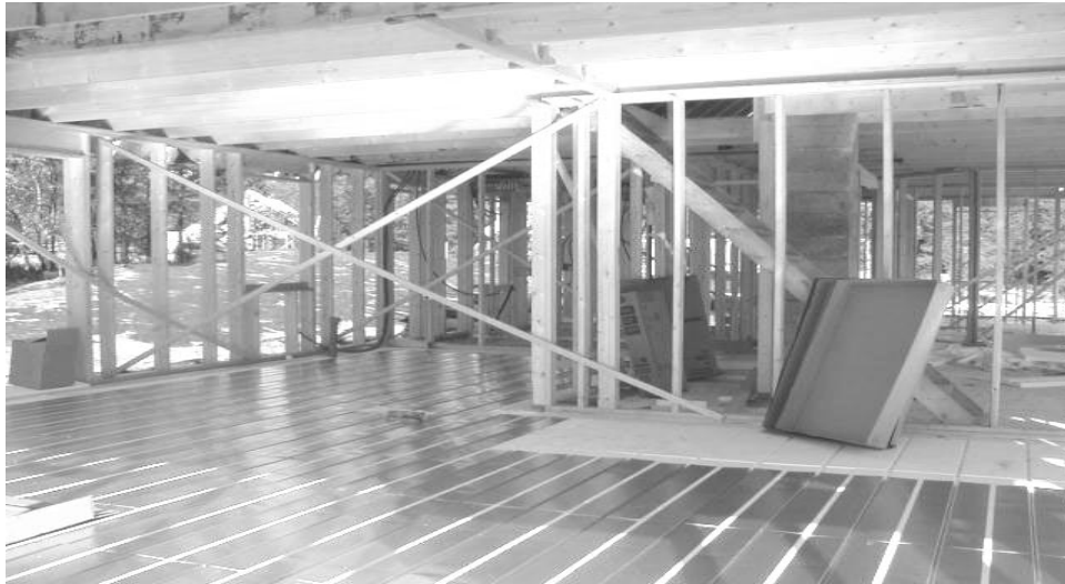
Fig. 5.3. Lett utførelse av gulv på grunnen med utlagte varmfordelingsplater for gulvvarmerør uten bruk av betong, fig. 5.1. Over varmfordelingsplatene legges glidesjikt (f.eks. plastfolie) deretter gipsplater og parkett.
