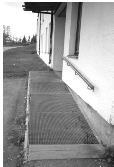
Rampe med gitterrister
