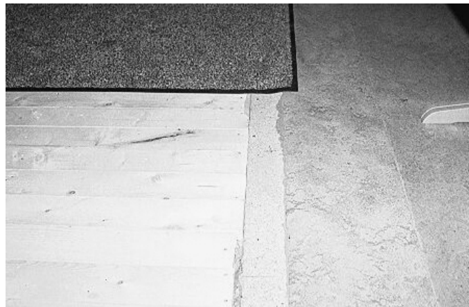
Skader og overganger i gulv/gulvbelegg vil by på problemer
