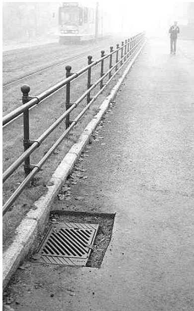
Kantstein og rekkverk gir god retningsmarkering, men selv denne nye gangveien har en skade som kan forårsake ulykker.
