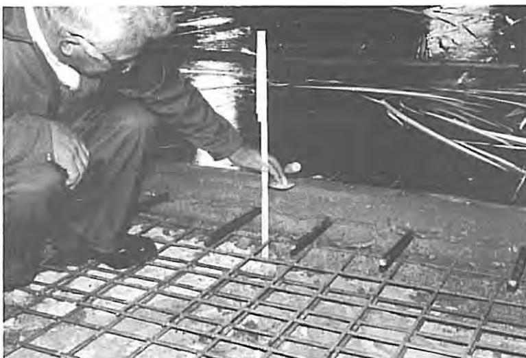
Fig. 2.43 c Støpeskjøt med dybelløsning. Her kontrolleres armeringsnettets plassering i et dobbeltarmert golv.
