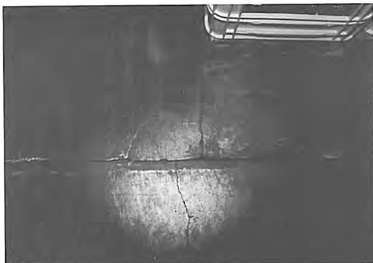
Fig. 2.42 c En T-skjøt hvor det framgår at støpeskjøten initierer sprekk i nabofeltet. Dette registrerte vi som en vanlig skade der feltene ble støpt i forband.
